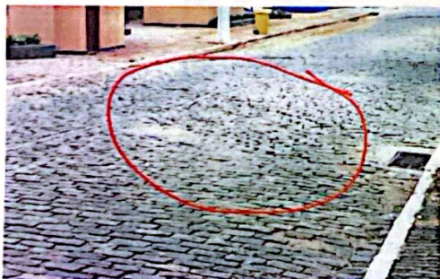
Depressão com risco de acidentes.
