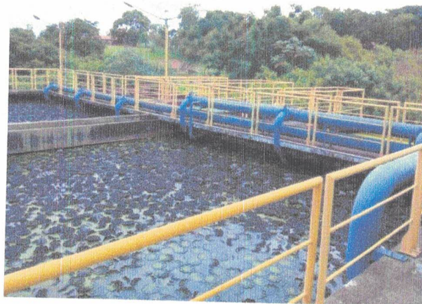
Figura 41 – Tanque de Aeração da ETE Barrinha
