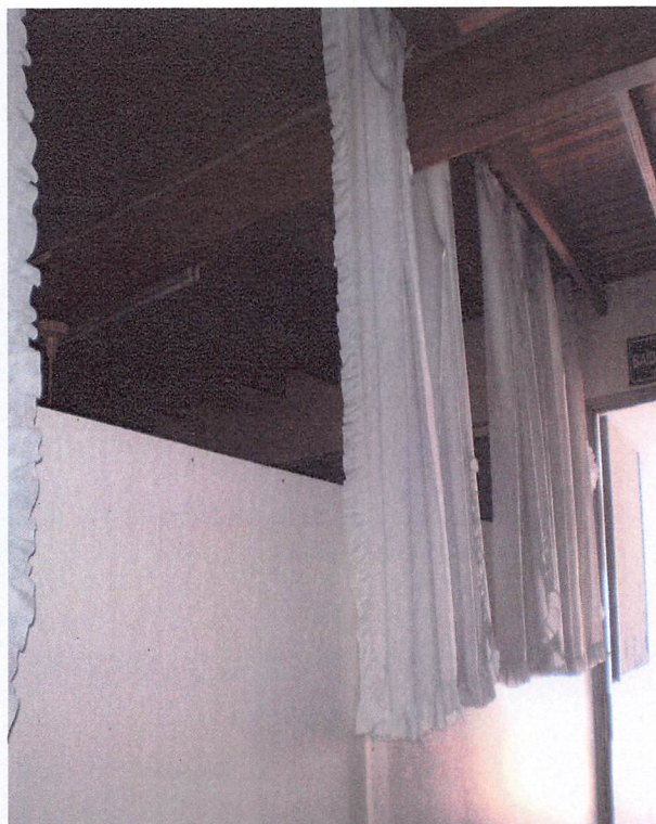
Divisória sem janela
