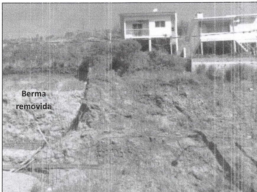
Figuras 5.18 e 5.19 - Taludes na Quadra G com altitudes e declividade tecnicamente condenáveis. Destaque para as bermas que foram mantidas em alguns lotes e em outros, removidas ou não implantadas.
