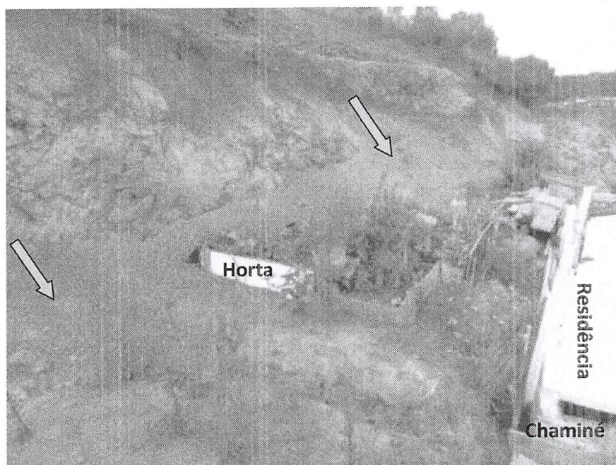
Figura 5.16 – Fragmentação dos riodacitos intemperizados e desbarrancamento dos taludes mal dimensionados (altura e ângulo). Talude da Quadra H.
