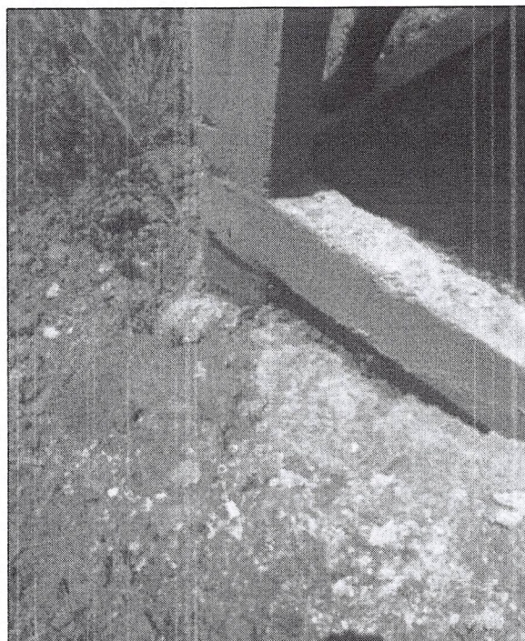
Figura 6.12 - Vista do encontro entre as vigas da fundação e um dos pescoços da sapata, evidenciando a excentricidade e carreamento do solo, para a edificação do Lote 3.
