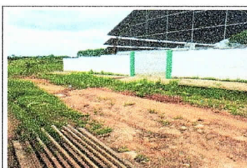
Foto 9 – Portão de acesso sem calçamento
