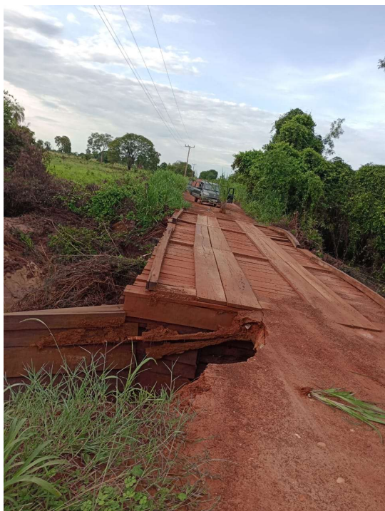
Ponte destruída na Com. Paiol
