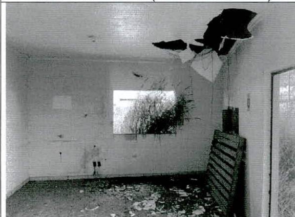
Foto 03 – Recepção totalmente depredada
