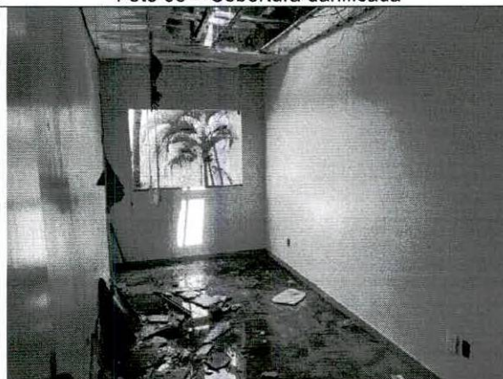
Foto 10 – Sala com piso e gesso depredados
