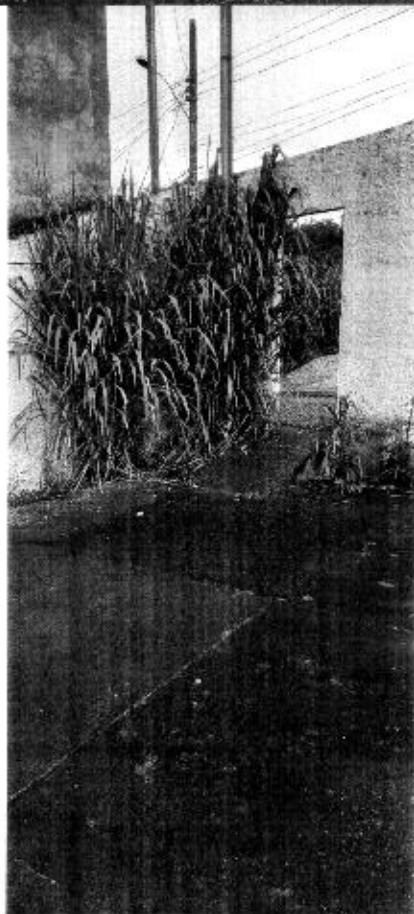
Figura 2 - Imóvel no bairro Baú precisa de reforma geral
