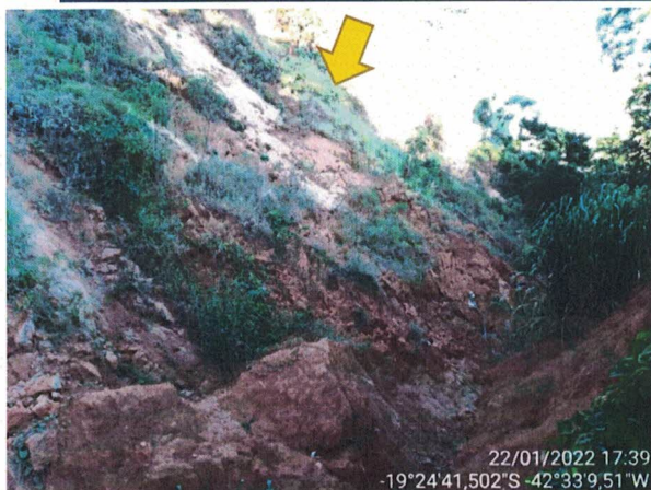
Foto 9 - Localização: Erosão da rua Alemanha; Data da foto: 22/01/2022; Obs.: Foto tirada dentro da erosão mostrando que ela ainda não havia se agravado próximo a seta indicada sobre a imagem.
