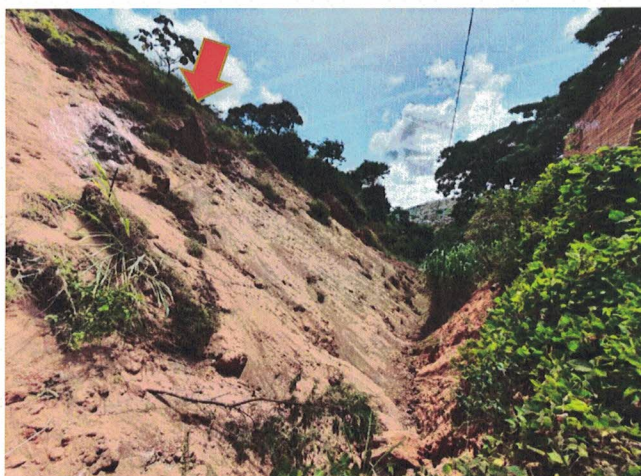
Foto 11 - Localização: Erosão da rua Alemanha; Data da foto: 25/01/2022; Obs.: Foto tirada dentro da erosão mostrando a movimentação de terra que ocorreu entre os dias 24/01 e 25/01 de 2022 no local da seta indicada sobre a imagem.
