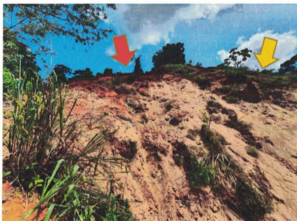
Foto 7 - Localização: Erosão da rua Alemanha; Data da foto: 25/01/2022; Obs.: Foto tirada dentro da erosão mostrando a movimentação de terra que ocorreu entre os dias 24/01 e 25/01 de 2022 no local das setas indicadas sobre a imagem.
