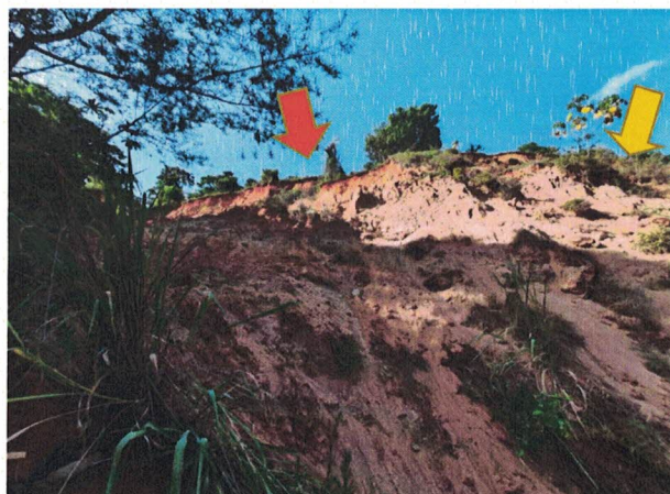
Foto 8 - Localização: Erosão da rua Alemanha; Data da foto: 27/01/2022; Obs.: Foto tirada dentro da erosão mostrando a movimentação de terra que ocorreu entre os dias 25/01 e 27/01 de 2022 no local das setas indicadas sobre a imagem.
