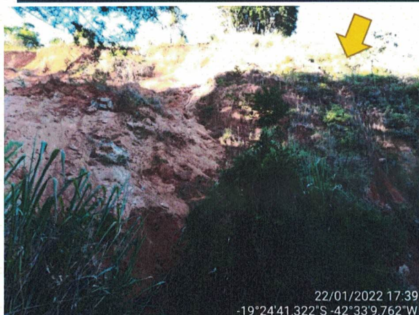
Foto 5 - Localização: Erosão da rua Alemanha; Data da foto: 22/01/2022; Obs.: Foto tirada dentro da erosão mostrando que ela ainda não havia se agravado próximo a seta indicada sobre a imagem.
