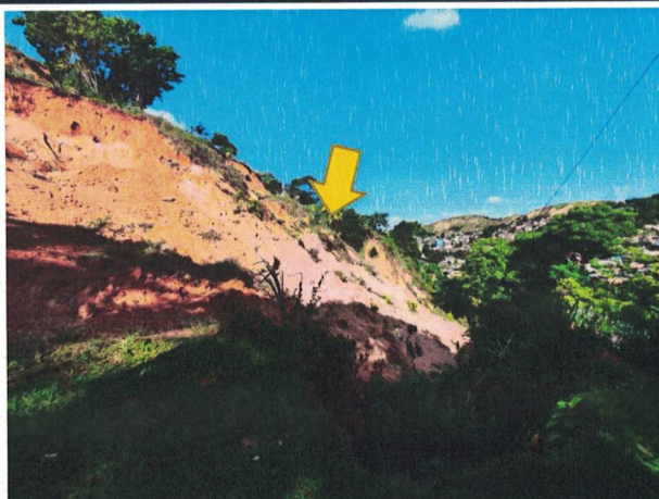
Foto 14 - Localização: Erosão da rua Alemanha; Data da foto: 27/01/2022; Obs.: Foto tirada dentro da erosão mostrando a movimentação de terra que ocorreu entre os dias 25/01 e 27/01 de 2022 no local da seta indicada sobre a imagem.
