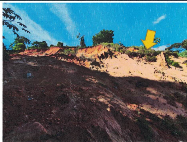
Foto 6 - Localização: Erosão da rua Alemanha; Data da foto: 24/01/2022; Obs.: Foto tirada dentro da erosão mostrando a movimentação de terra que ocorreu entre os dias 22/01 e 24/01 de 2022 no local da seta indicada sobre a imagem.
