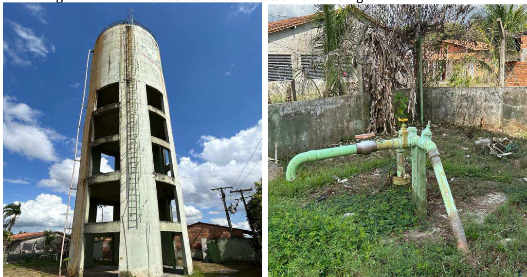
Figura 27 e 28: Microssistema de Abastecimento de Água - Bairro de Fátima
