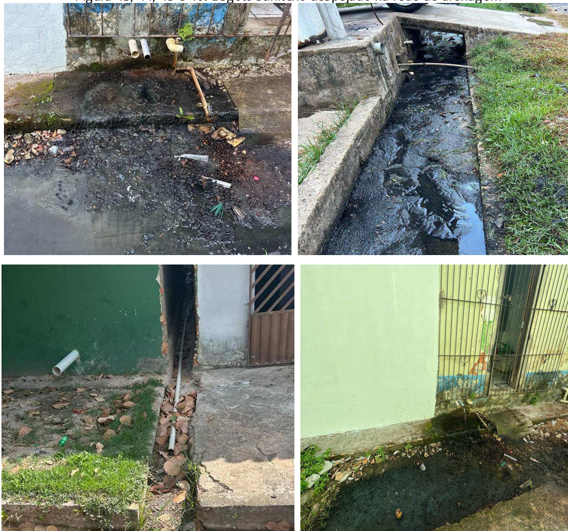
Figura 43, 44, 45 e 46: Esgoto sanitário despejado na rede de drenagem
