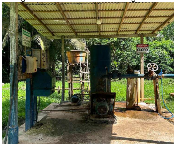
Figura 19: Unidade elevat@ria de @gua bruta
