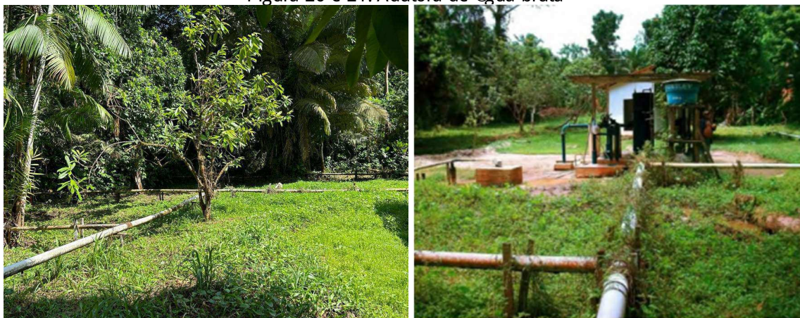
Figura 20 e 21: Adutora de @gua bruta
