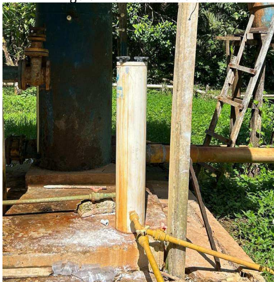
Figura 22: Dosador de cloro
