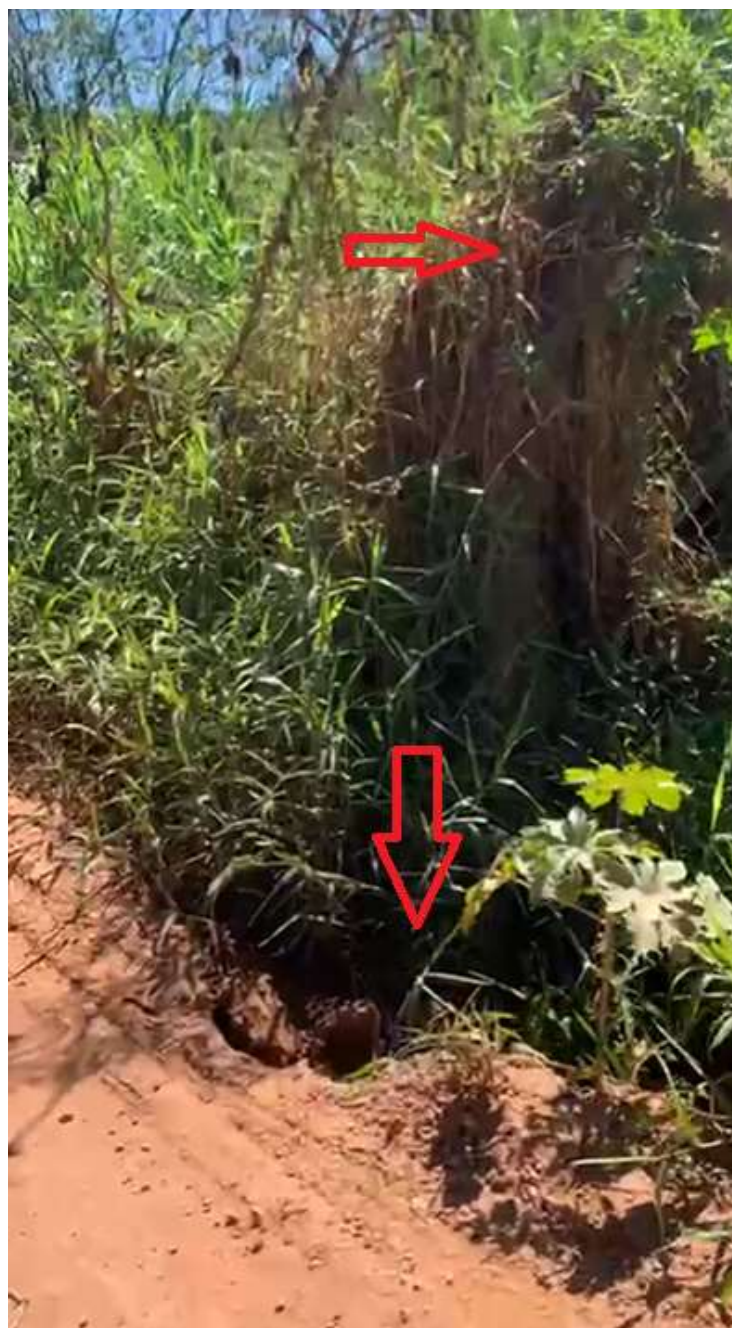
Seta superior – placa indicativa de lombada obstruída Seta inferior – bueiro obstruído
