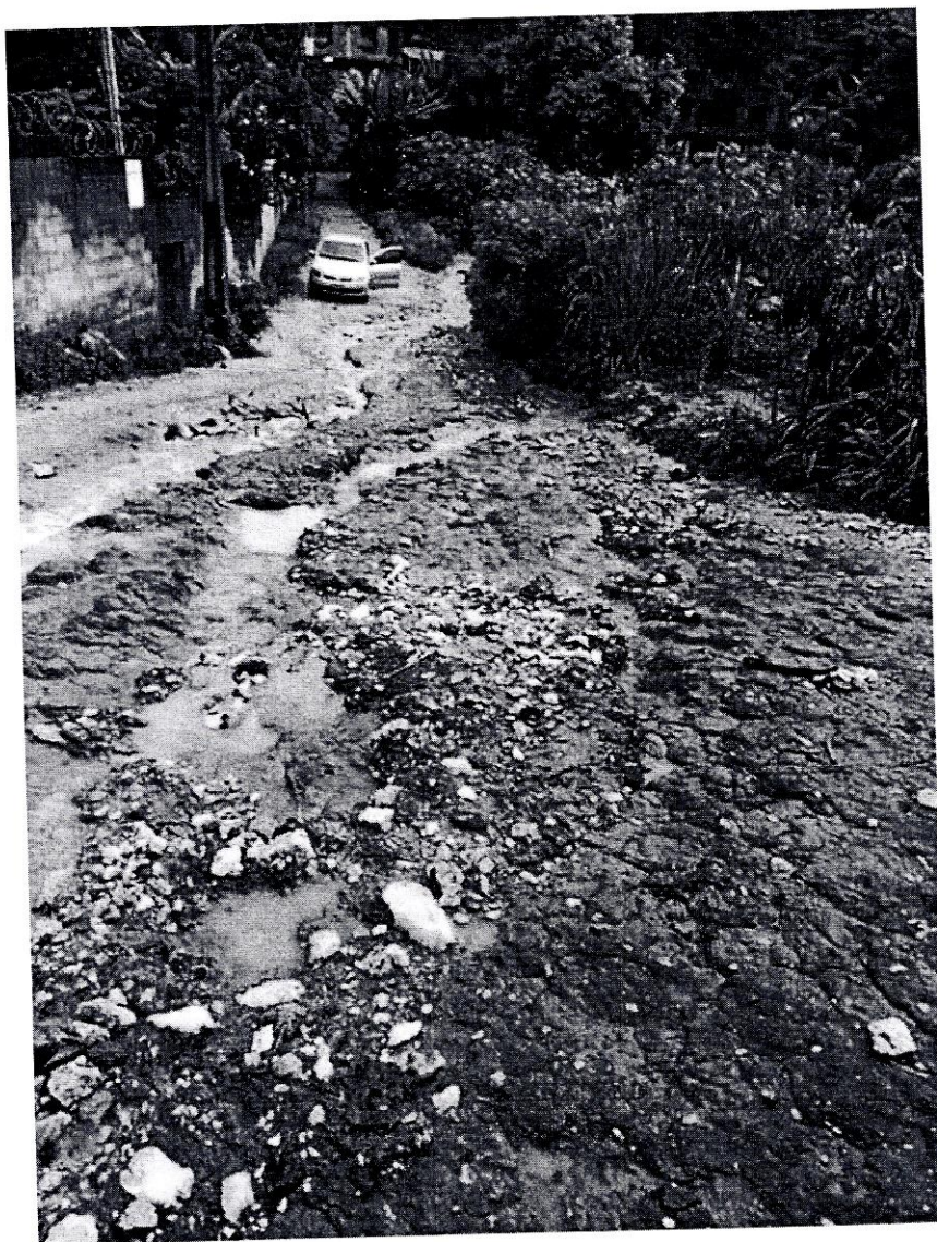
Rua em estado crítico na Fazendinha.
