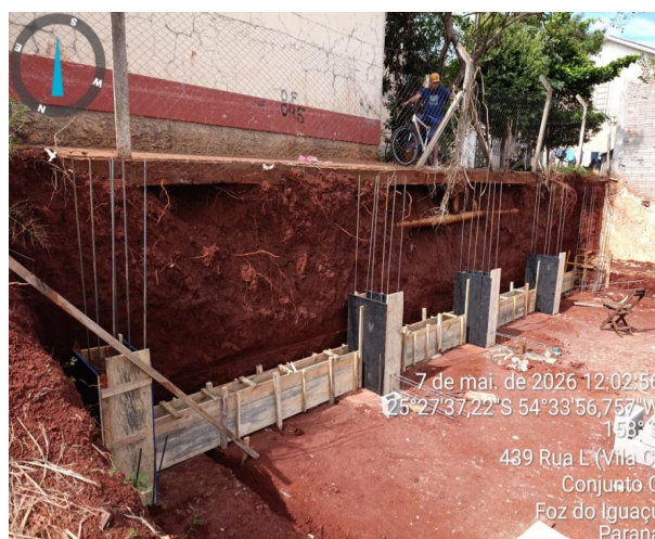
Imagem 6 - Muro em execução por parte do vizinho, evidenciando a estrutura da calçada e parte da tubulação do conjunto habitacional exposta.
