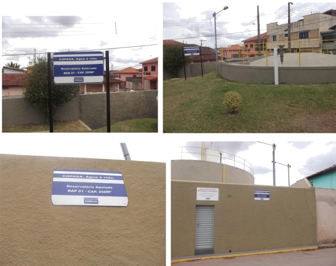
Figura 16 - Fotos dos reservatórios REN01(enterrado) e RAP01 (apoiado).
