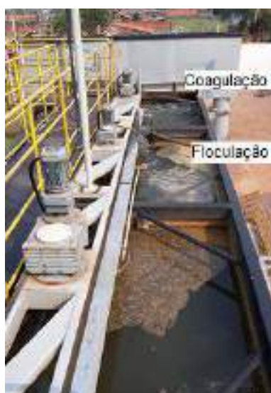
Figura 22— Detalhe da coagulação e floculação da ETA Convencional Compacta de Pimenta Bueno.
