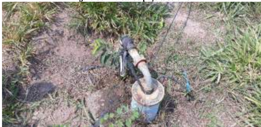
Figura 50— Vista do poço tubular 01
