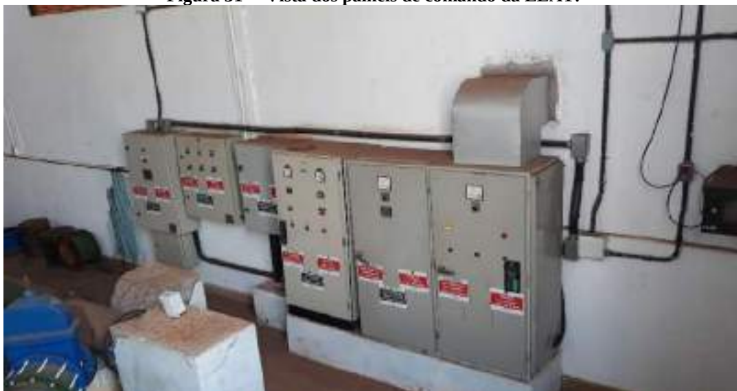
Figura 31— Vista dos painéis de comando da EEAT.
