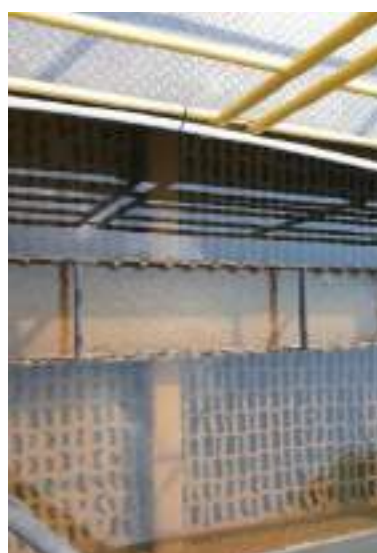
Figura 23— Detalhe da decantação de alta taxa da ETA Convencional Compacta de Pimenta Bueno.
