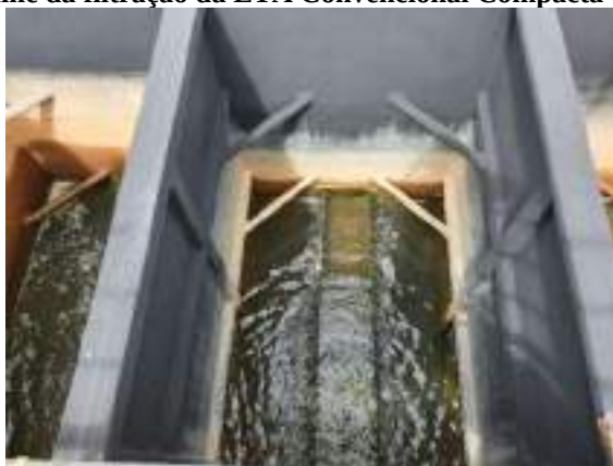
Figura 24— Detalhe da filtração da ETA Convencional Compacta de Pimenta Bueno.
