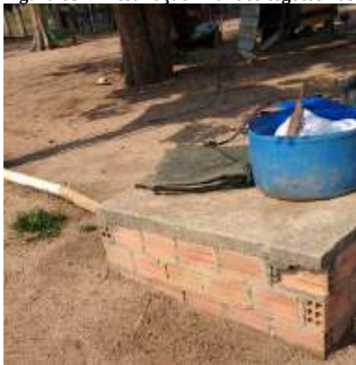
Fossa rudimentar no Assentamento Marta Regina na zona rural
