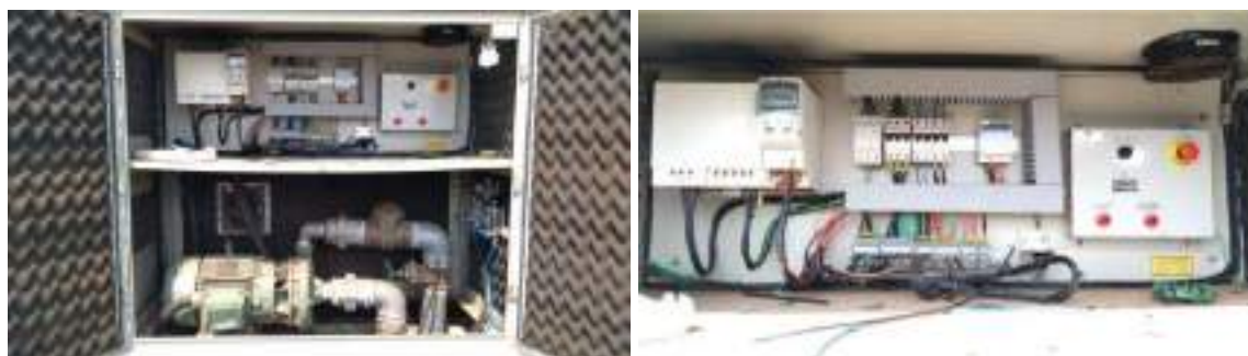
Figura 36— Painel de comando do booster.
