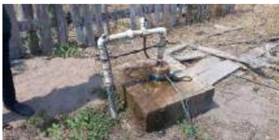
Figura 52— Vista do poço tubular 02.
