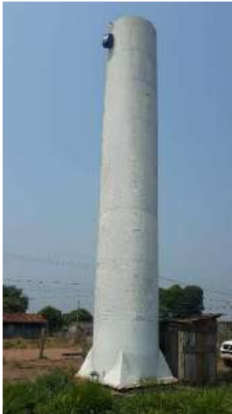
Figura 57— Reservatório Elevado do Distrito Urucumacua.
