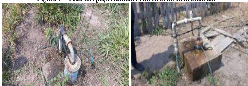
Figura 7 - Vista dos poços tubulares do Distrito Urucumacũ.
