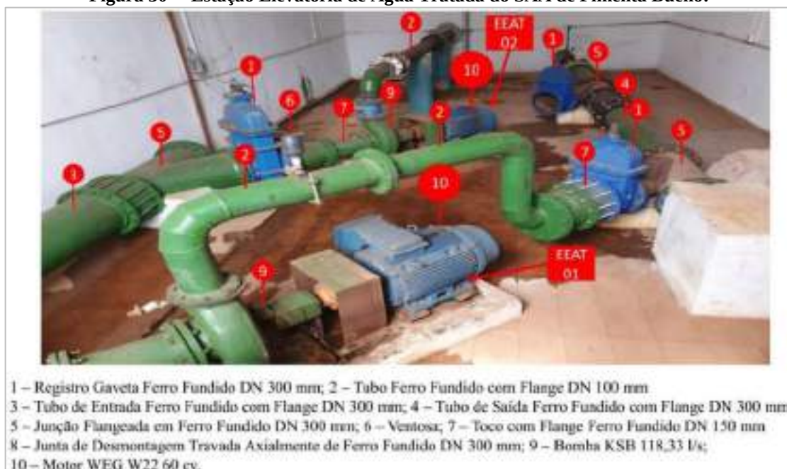
Figura 30— Estação Elevatória de Água Tratada do SAA de Pimenta Bueno.
