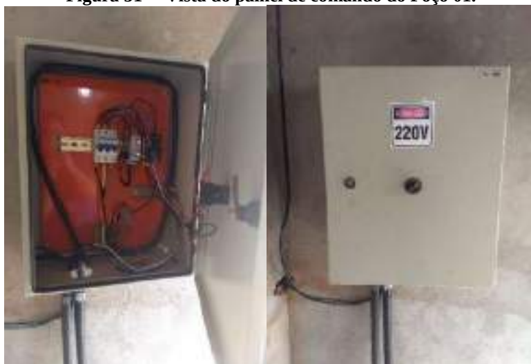
Figura 51— Vista do painel de comando do Poço 01.
