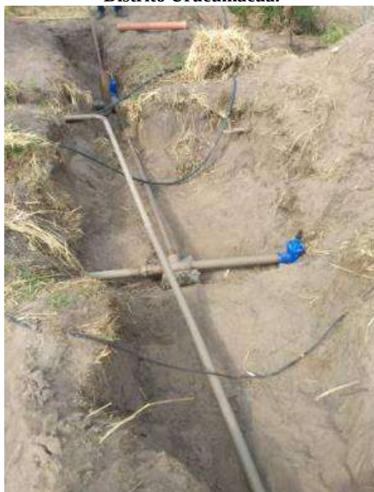
Figura 59— Registros gaveta de Ferro Fundido DN 50 mm de interligação do reservatório do SAA do Distrito Urucumacã.
