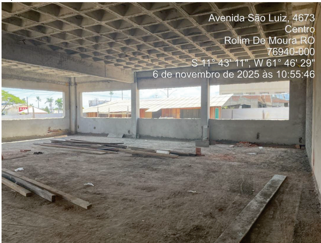
Imagem 01- Indicação pavimento térreo face irregular.
