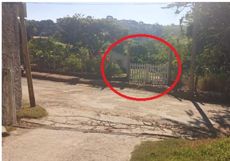
Imóvel situado na Estrada do Saltinho, diretamente impactado pelo escoamento da água pluvial proveniente da Rua João Bruno.
