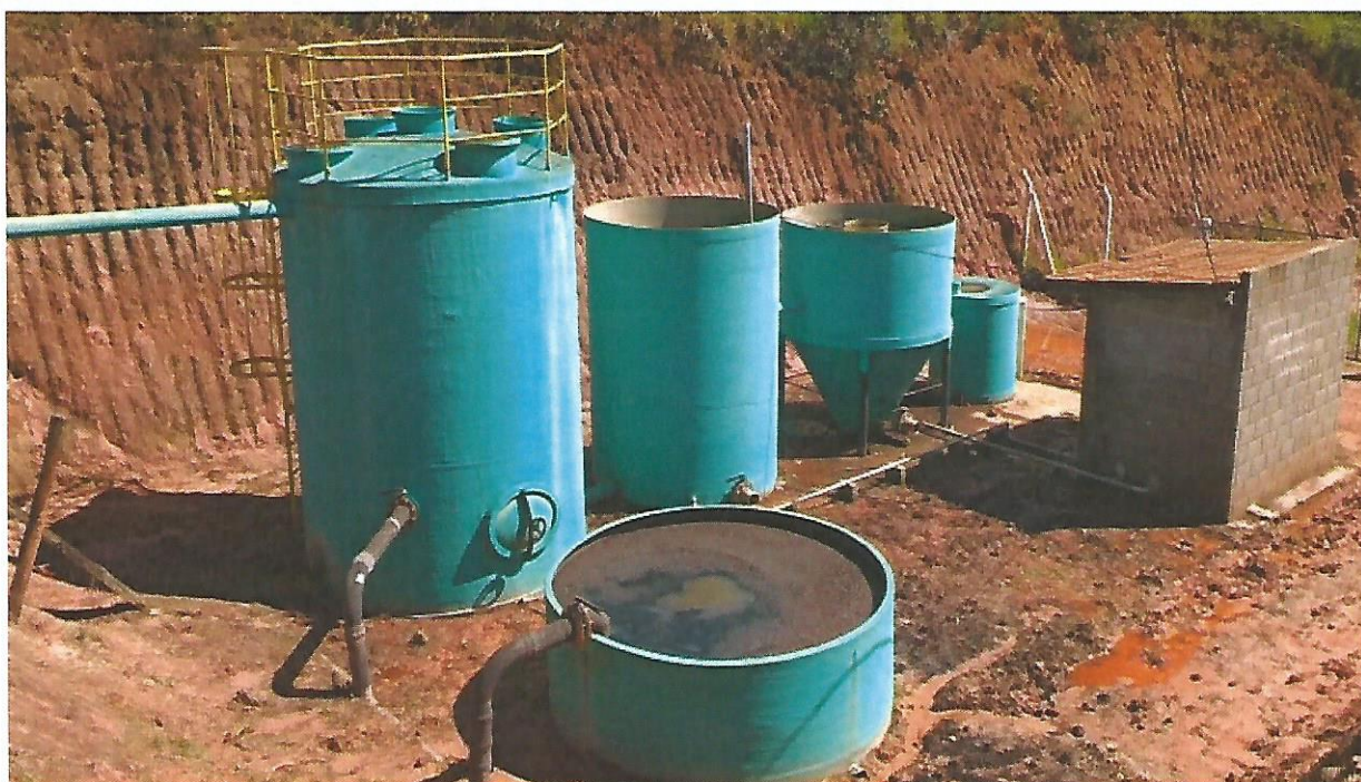
Figura 4 – Estação de tratamento de esgoto compacta
