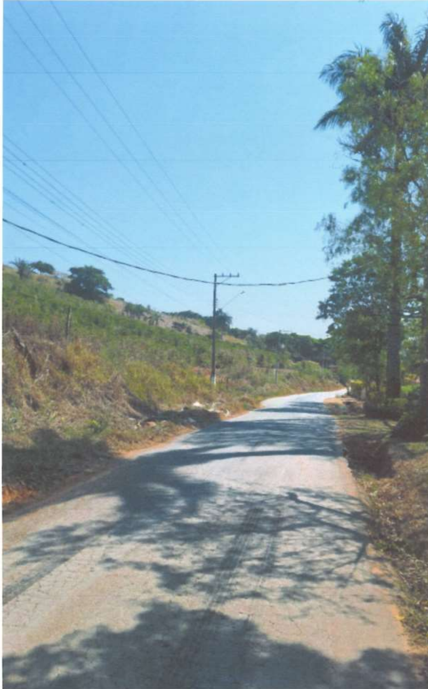
Frenagens no asfalto
