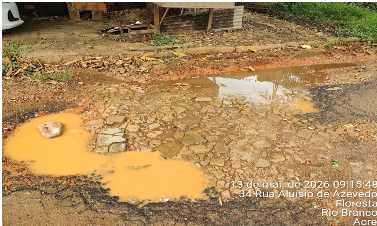
Trecho danificado por problemas na drenagem
