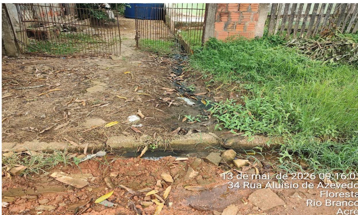
Falta de canalização do esgotamento sanitário
