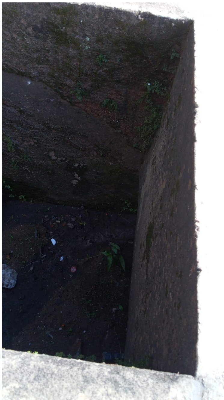
Boca lobo escadaria da Vila Gonalo
