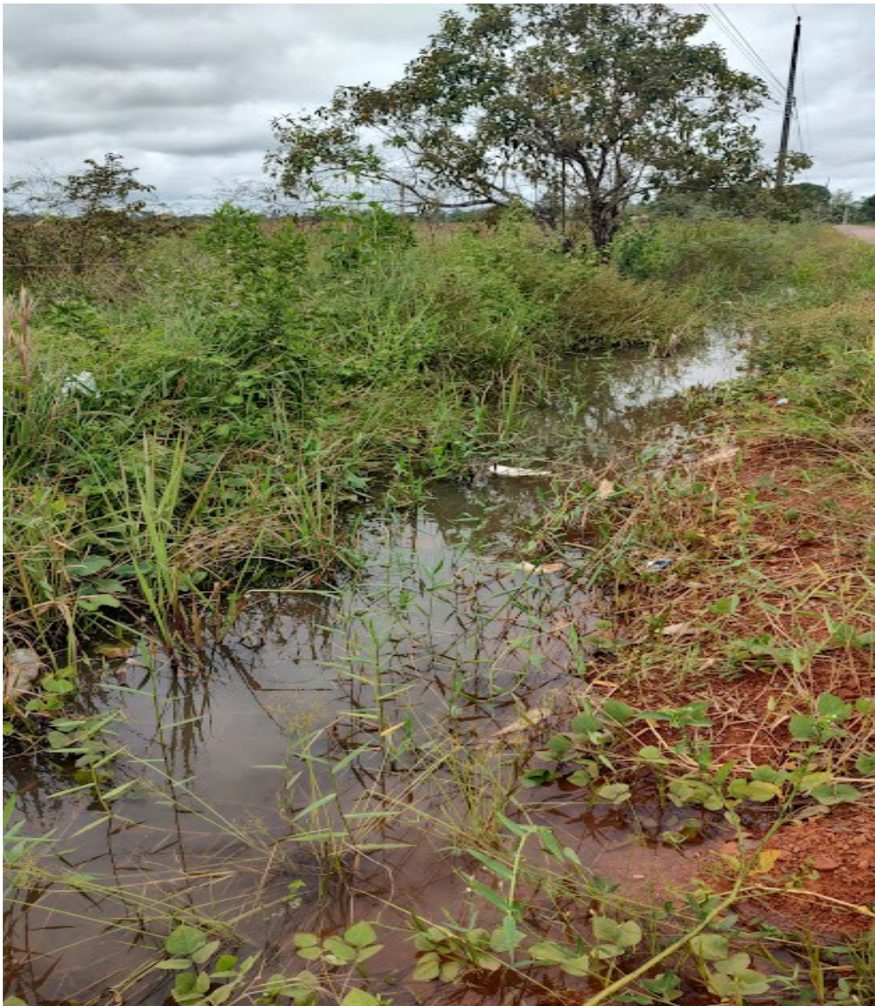
Vista de um trecho de uma das laterais com mato/capim e acúmulo de água
