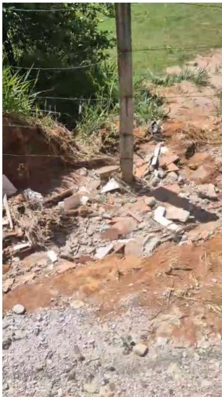
Valeta coberta por entulho
