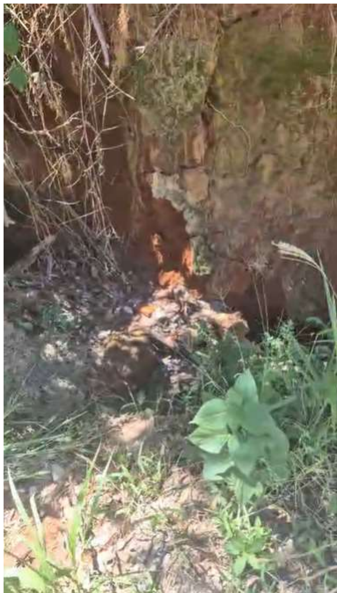
Erosão do barranco
