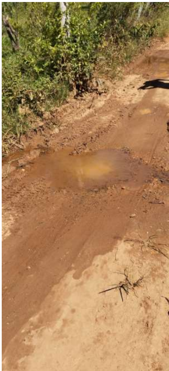
Acúmulo de água pluvial
