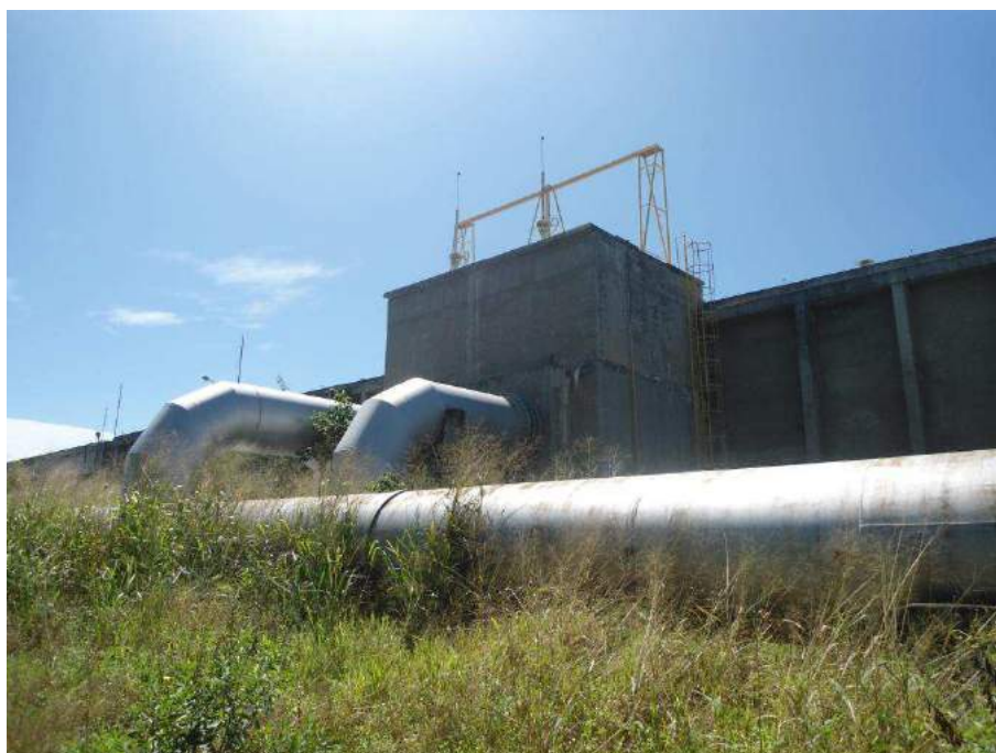
Figura 7.32 – Vista da tubulação de chegada do RAP-Ancuri de 80.000 m 3 .
