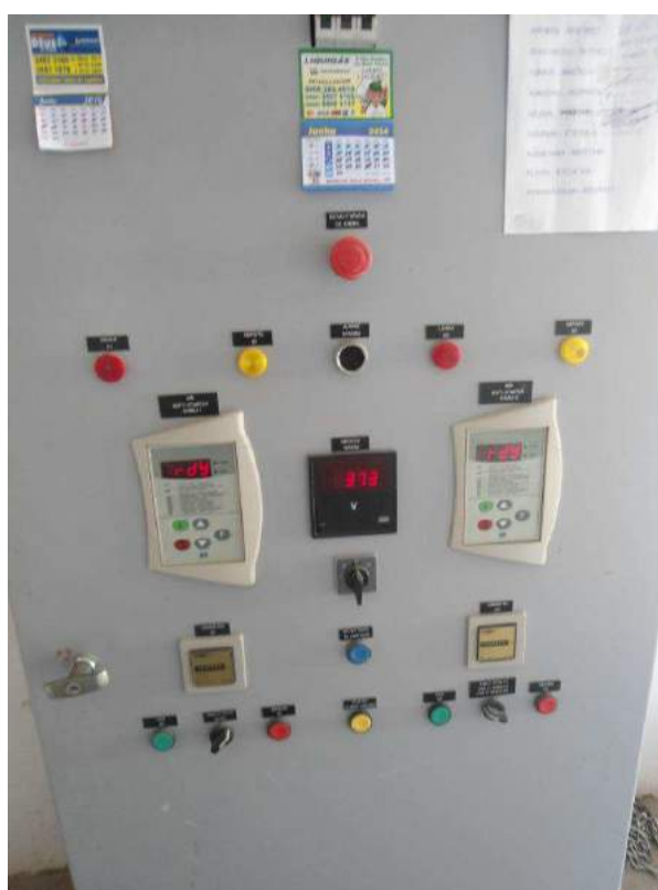
Figura 7.56 – Quadro de comando da estação elevatória EEE-03 (Rua José Bento – Bairro Guaribas) do sistema de esgotamento sanitário do Eusébio/CE.
