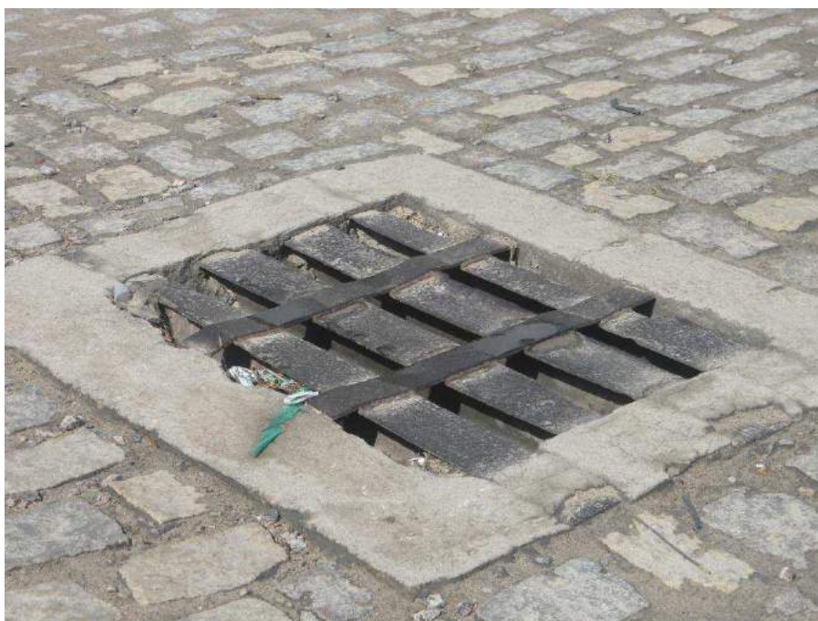
Figura 7.131 – Dispositivo de drenagem (caixa de drenagem) na Praça do Pólo.
