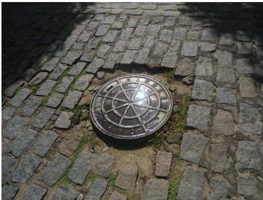
Figura 7.42 – Vista superior de poço de visita, na Rua Irmã Ambrosina, que compõe o sistema de esgotamento sanitário do Eusébio/CE.
