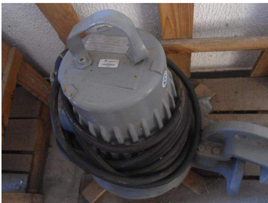
Figura 7.68 – Bomba reserva da estação elevatória EEE-08 (Rua Beira Rio – Condomínio Jardim Ibiza) do sistema de esgotamento sanitário do Eusébio/CE.
