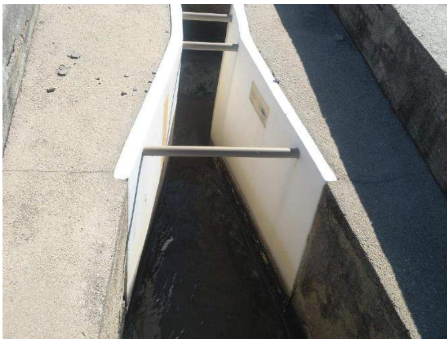
Figura 7.89 – Vista da calha parshall da ETE do Eusébio/CE, localizada no município de Aquiráz/CE.
