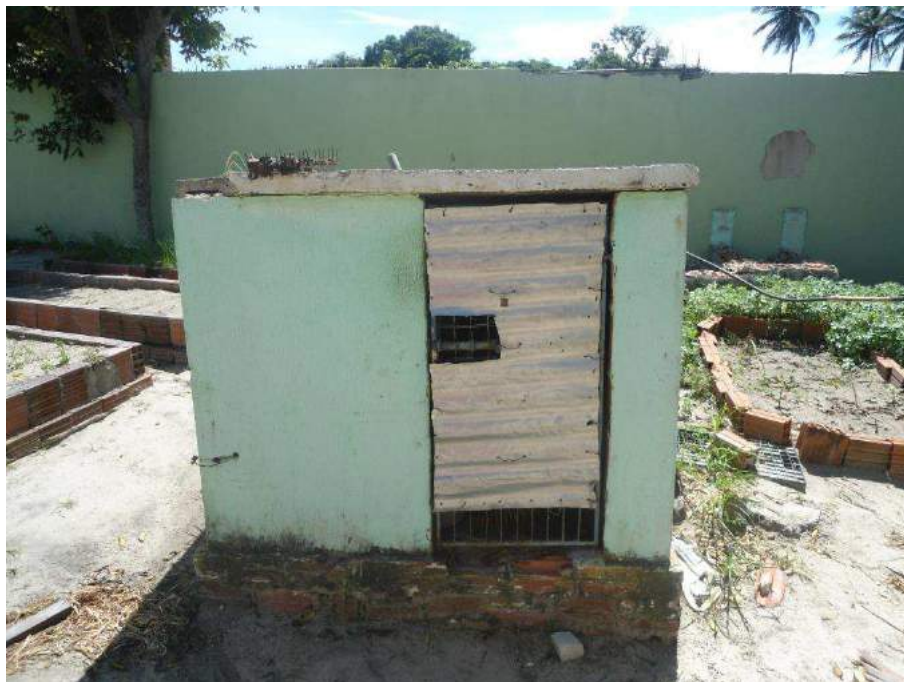
Figura 7.37 – Vista do poço no bairro Olho D'Água.
