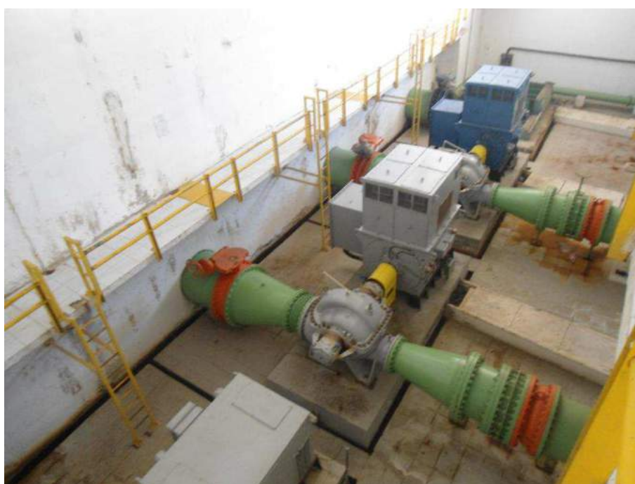
Figura 7.26 – Vista das bombas da estação elevatória de água tratada da ETA.
