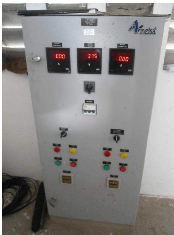
Figura 7.78 – Quadro de comando da estação elevatória EEE-09 (Rua Santo Antônio – Bairro Parque Havaí) do sistema de esgotamento sanitário do Eusébio/CE.
