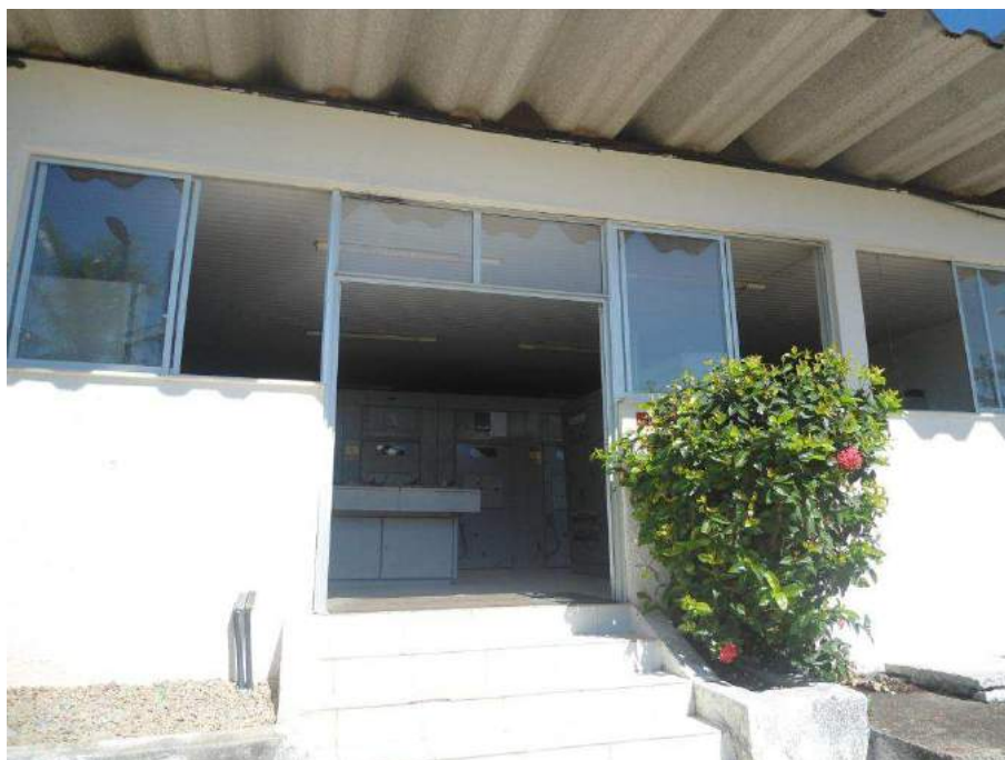
Figura 7.23 – Vista da casa de bombas da estação elevatória de água tratada da ETA.
