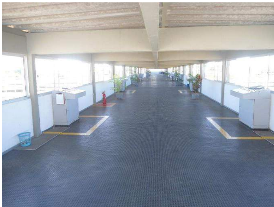
Figura 7.14 – Vista da unidade de filtração da ETA.
