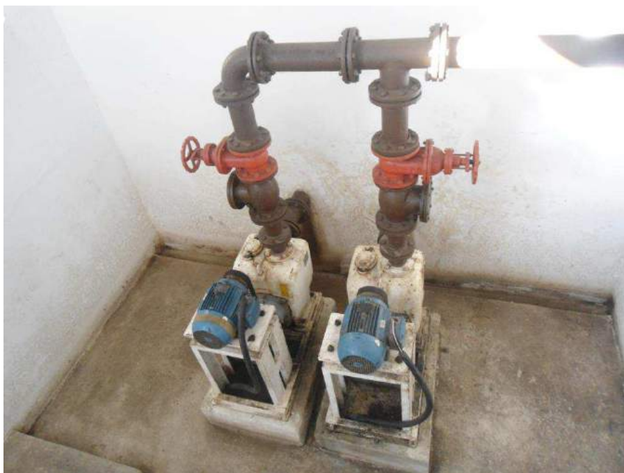
Figura 7.75 – Bombas da estação elevatória EEE-09 (Rua Santo Antônio – Bairro Parque Havaí) do sistema de esgotamento sanitário do Eusébio/CE.
