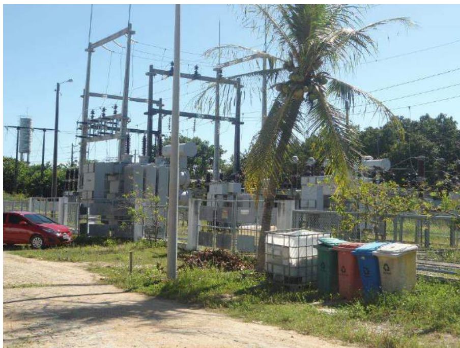
Figura 7.22 – Vista da sub-estação da ETA.
