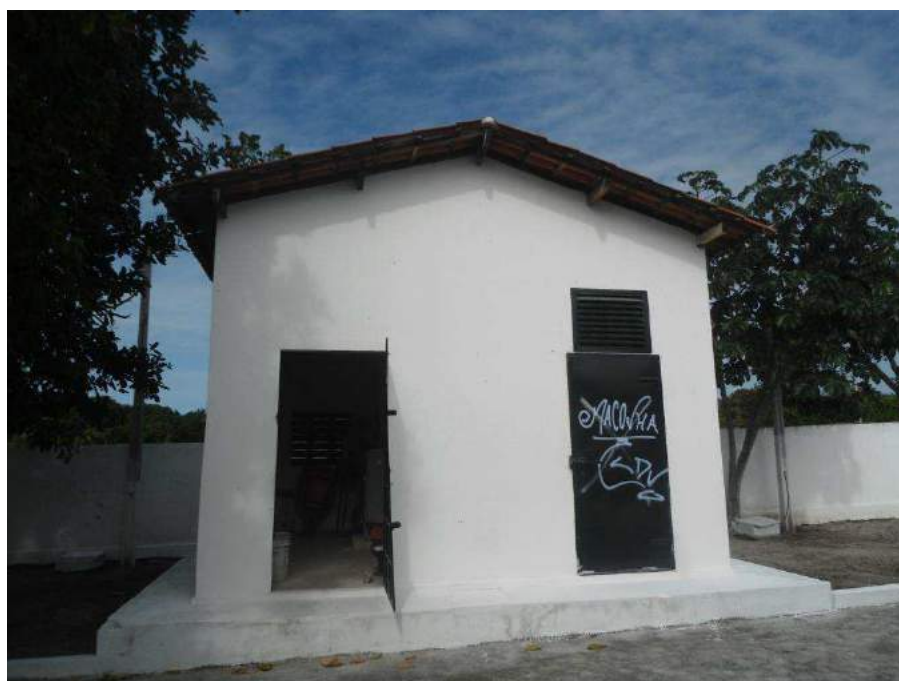
Figura 7.48 – Vista da casa do quadro de comando/gerador da estação elevatória EEE-02 (Rua Acilon Gonçalves – Bairro Guaribas) do sistema de esgotamento sanitário do Eusébio/CE.
