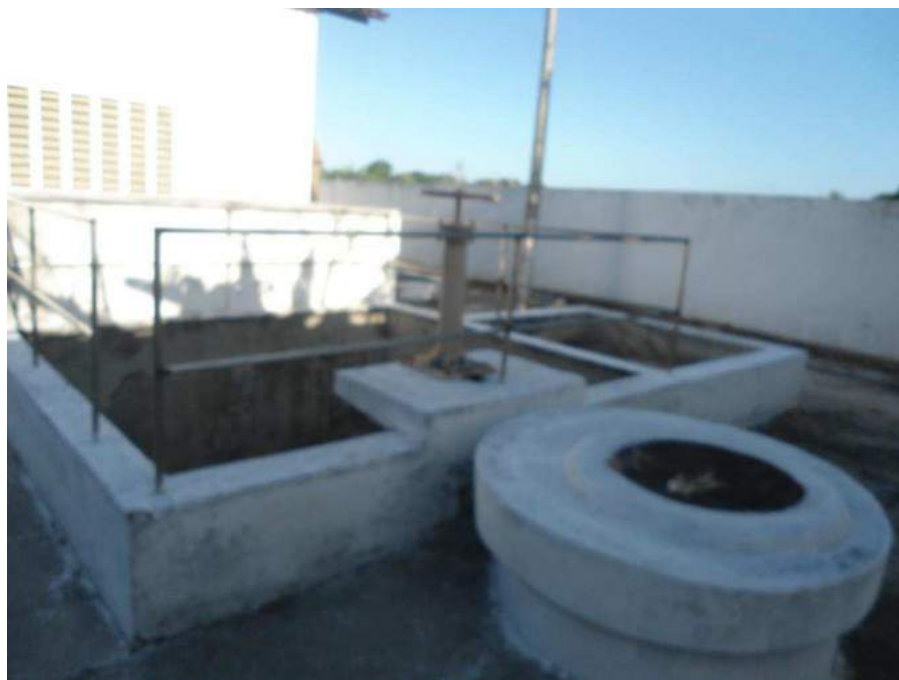
Figura 7.81 – Vista do poço de sucção da estação elevatória EEE-10 (Rua Wilson Milfhon – Bairro Alagoinha) do sistema de esgotamento sanitário do Eusébio/CE.
