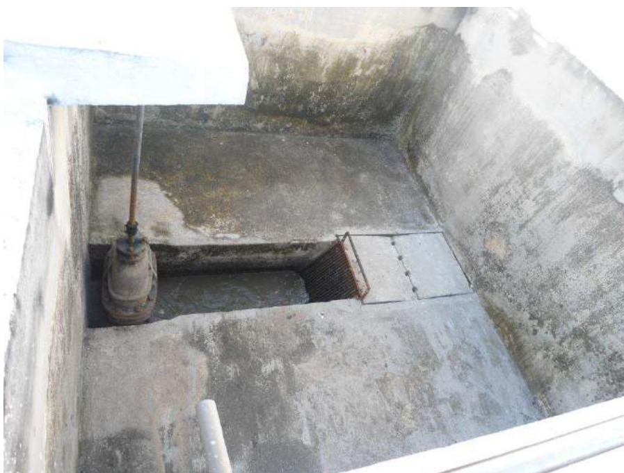
Figura 7.80 – Vista do tratamento preliminar (grade) da estação elevatória EEE-10 (Rua Wilson Milfhon – Bairro Alagoinha) do sistema de esgotamento sanitário do Eusébio/CE.
