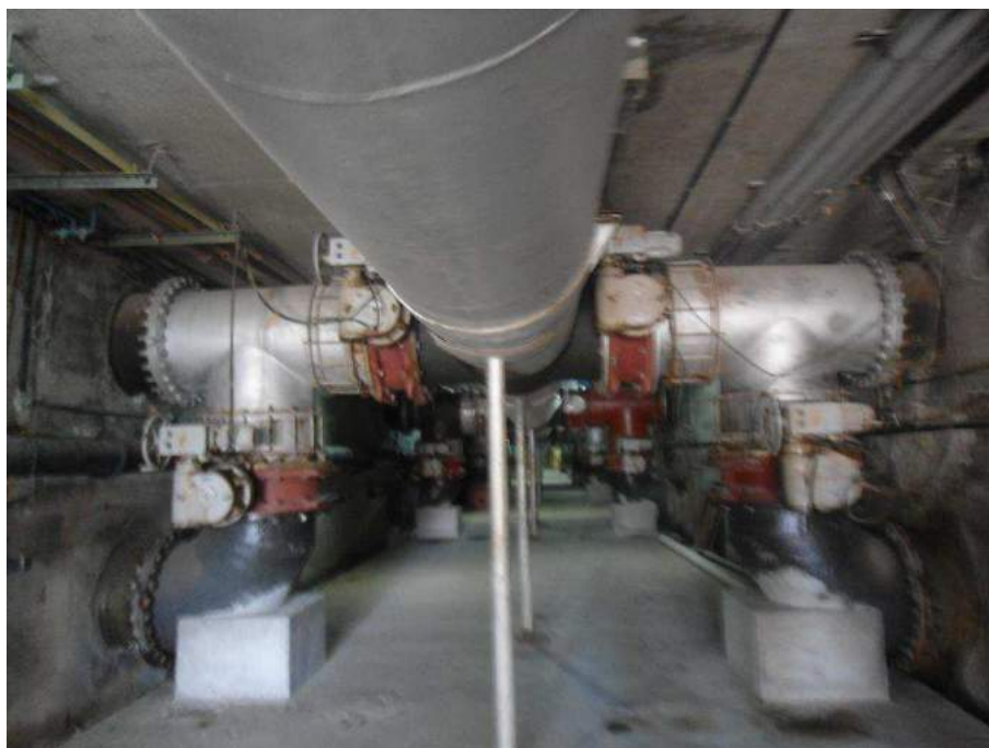
Figura 7.12 – Vista da tubulação interna da ETA.
