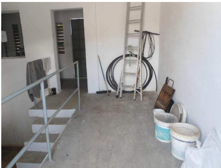
Figura 7.77 – Vista interna da casa do quadro de comando/bombas da estação elevatória EEE-09 (Rua Santo Antônio – Bairro Parque Havaí) do sistema de esgotamento sanitário do Eusébio/CE.
