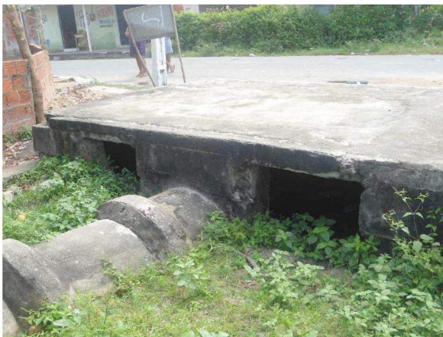
Figura 7.137 – Tubulação de drenagem no Parque Havaí.
