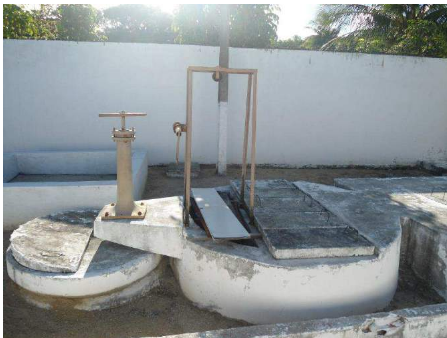
Figura 7.53 – Vista do poço de sucção da estação elevatória EEE-03 (Rua José Bento – Bairro Guaribas) do sistema de esgotamento sanitário do Eusébio/CE.
