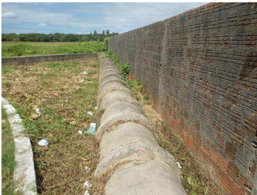
Figura 7.132 – Tubulação de drenagem na Praça do Pólo.
