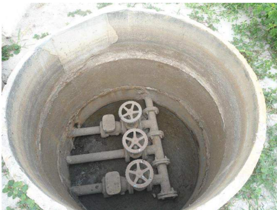
Figura 7.127 – Tubulação de chegada do chorume para a ETE (lagoas) do Aterro Sanitário Metropolitano Leste (ASML).
