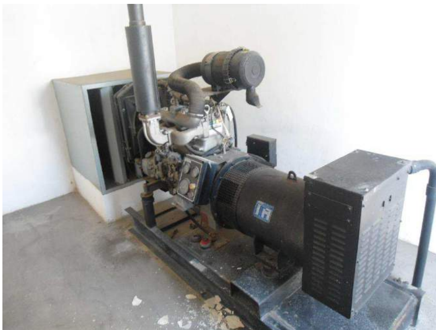
Figura 7.57 – Gerador da estação elevatória EEE-03 (Rua José Bento – Bairro Guaribas) do sistema de esgotamento sanitário do Eusébio/CE.
