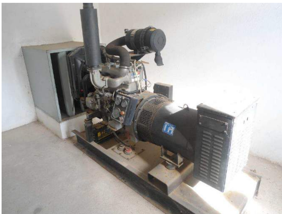
Figura 7.50 – Gerador da estação elevatória EEE-02 (Rua Acilon Gonçalves – Bairro Guaribas) do sistema de esgotamento sanitário do Eusébio/CE.
