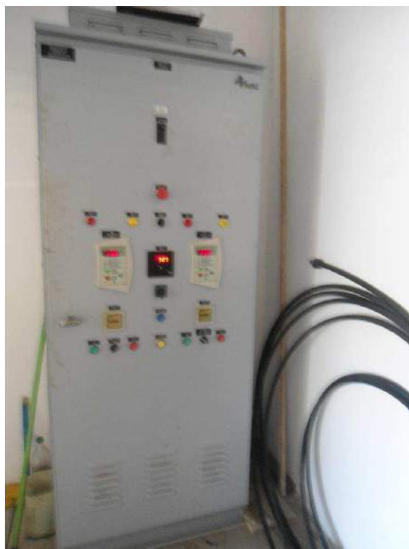
Figura 7.84 – Vista interna da casa do quadro de comando/bombas da estação elevatória EEE-10 (Rua Wilson Milfhon – Bairro Alagoinha) do sistema de esgotamento sanitário do Eusébio/CE.
