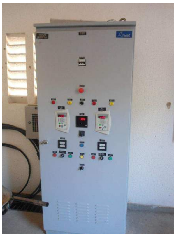
Figura 7.70 – Quadro de comando da estação elevatória EEE-08 (Rua Beira Rio – Condomínio Jardim Ibiza) do sistema de esgotamento sanitário do Eusébio/CE.
