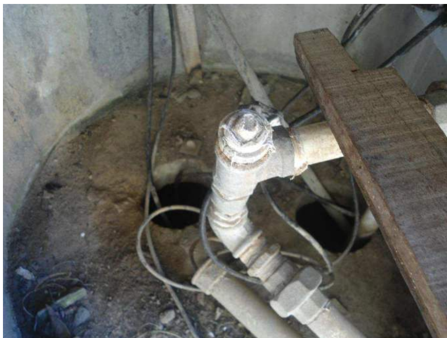
Figura 7.35 – Vista do poço no bairro Olho D'Água.
