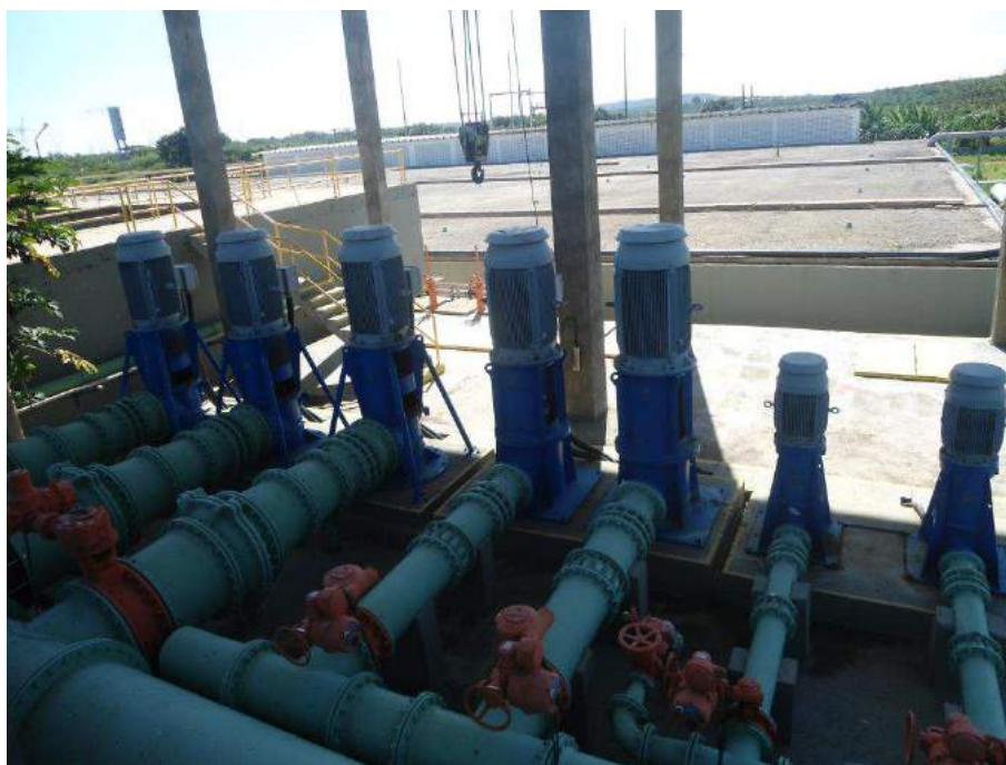
Figura 7.15 – Vista das bombas de lavagem dos filtros da ETA.
