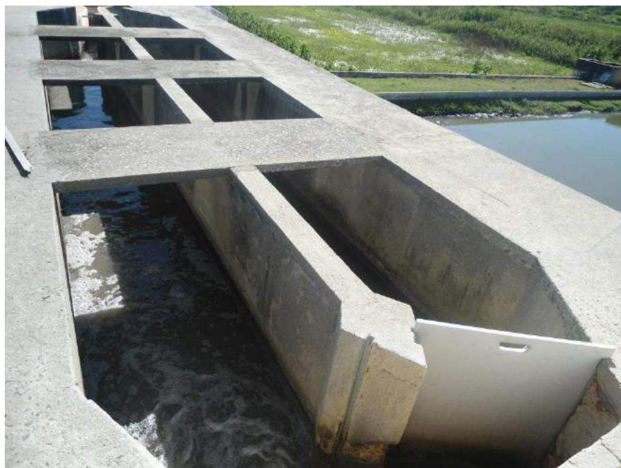
Figura 7.88 – Vista do tratamento preliminar (caixa de areia) da ETE do Eusébio/CE, localizada no município de Aquiráz/CE.
