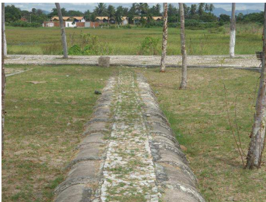
Figura 7.133 – Tubulação de drenagem na Praça do Pólo.
