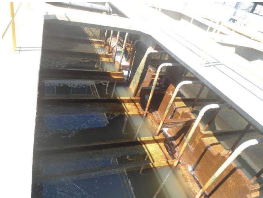
Figura 7.18 – Vista da lavagem dos filtros da ETA.
