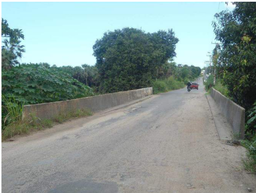
Figura 7.156 – Vista da Ponte à Estrada do Fio, havendo alagamentos na área.
