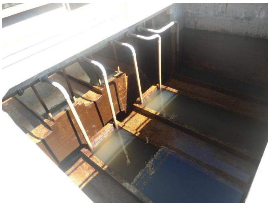
Figura 7.17 – Vista da lavagem dos filtros da ETA.
