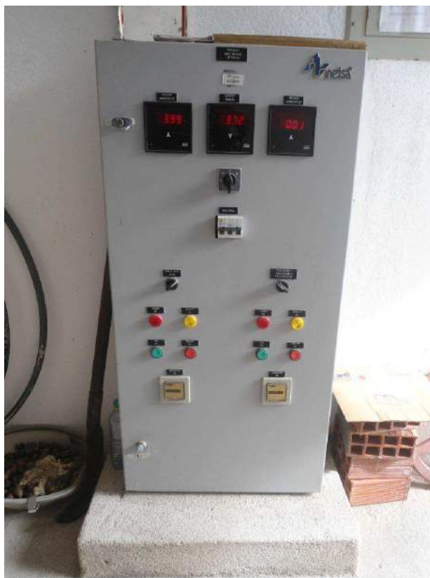
Figura 7.49 – Quadro de comando da estação elevatória EEE-02 (Rua Acilon Gonçalves – Bairro Guaribas) do sistema de esgotamento sanitário do Eusébio/CE.
