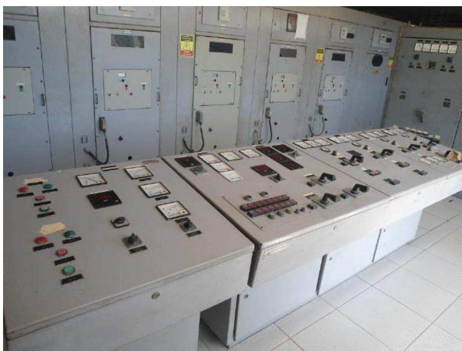
Figura 7.24 – Vista dos quadros de comando da estação elevatória de água tratada da ETA.
