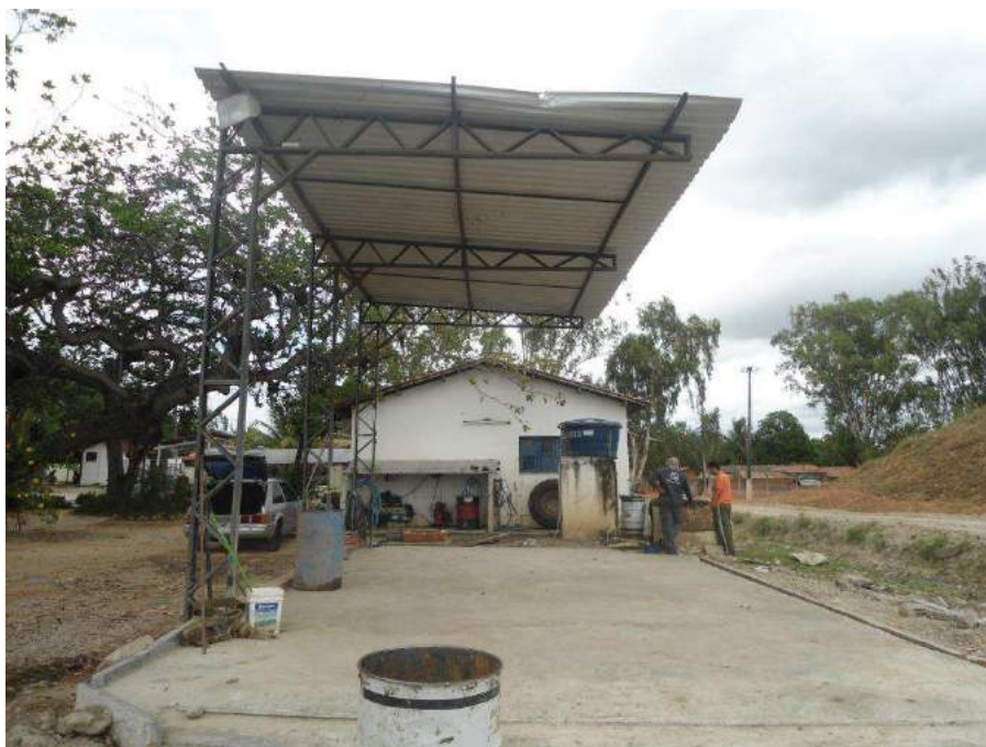
Figura 7.125 – Local para lavagem e desinfecção de veículos do Aterro Sanitário Metropolitano Leste (ASML).
