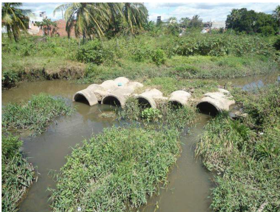
Figura 7.154 – Vista da drenagem na Ponte à Rua Duarte Coelho em péssimo estado de conservação, havendo alagamentos na área.
