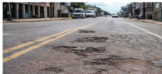
Detorioração do pavimento asfáltico na rodovia BR-070 (Avenida São Luiz), apresentando risco à segurança dos motoristas.
