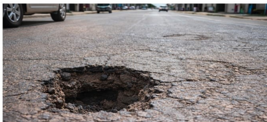
Cratera profunda no pavimento da rodovia BR-070 (Avenida São Luiz) no perímetro urbano de Cáceres-MT.
