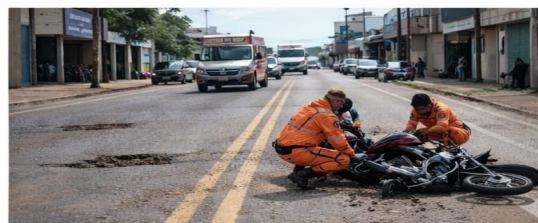
Ocorrência em avenida em que ocorreu acidente o motociclista caiu devido a buracos no asfalto da BR-070 dentro do perímetro urbano de Cáceres-MT.
