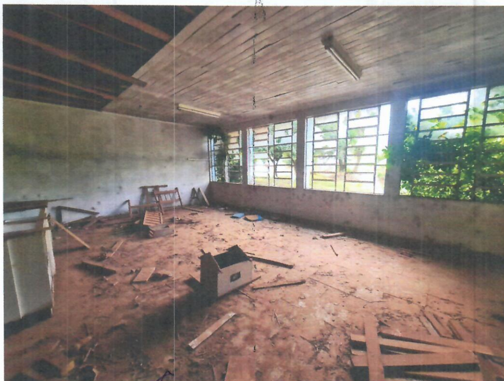
Foto 13-Interior da edificação local insalubre, forros danificados
