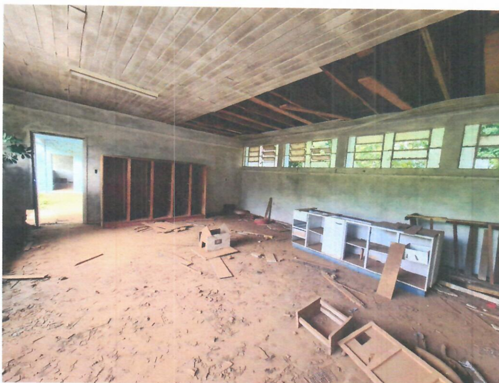
Foto 14-Interior da edificação local insalubre, forros danificados
