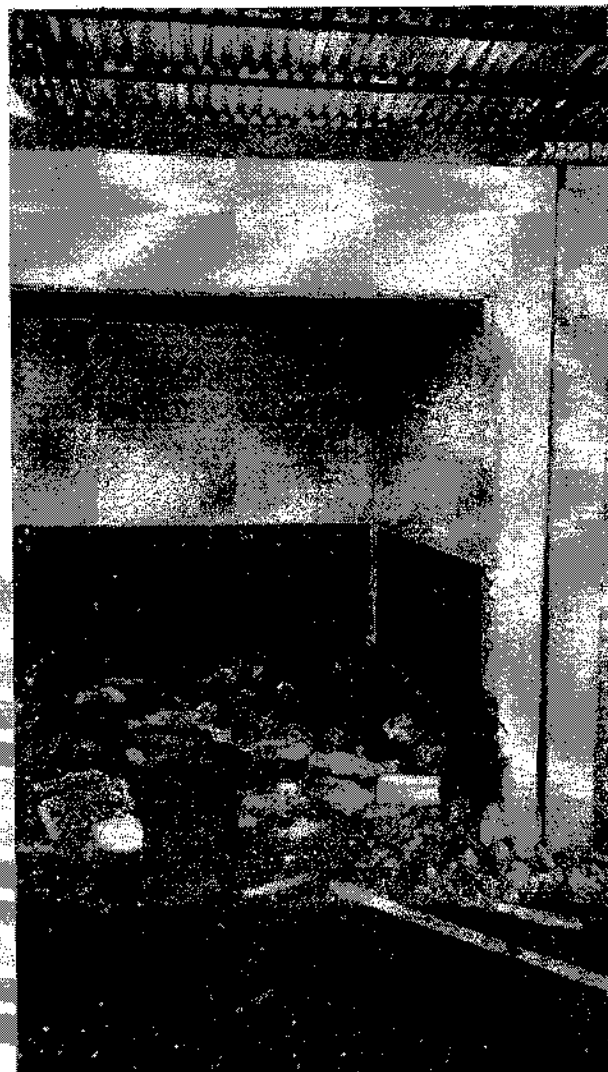
Figura 22 - Imagem das patologias do bem avaliado. Fonte: Arquivo pessoal. Fevereiro de 2019.
