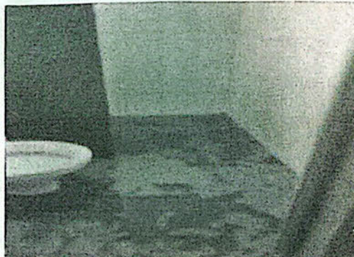
Figura 3 - Danos materiais causados pela enxurrada de lama no imóvel (Imagem de 26 de outubro de 2024)
