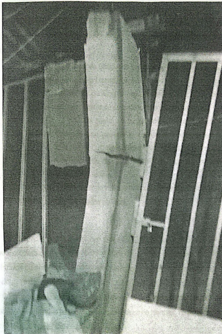
Figura 5 – Comprometimento estrutural na varanda aos fundos do imóvel e danos materiais (Imagem de 26 de outubro de 2024).
