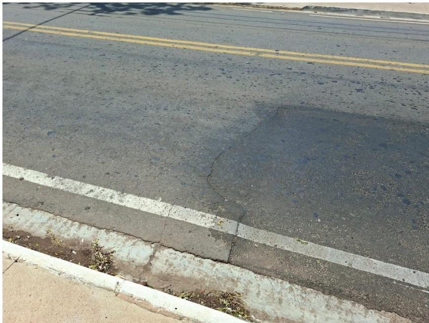
Imagem 35: Trecho do pavimento asfáltico danificado em trecho da avenida. – Arquivo da Secretaria Municipal de Planejamento Urbano e Meio Ambiente.
