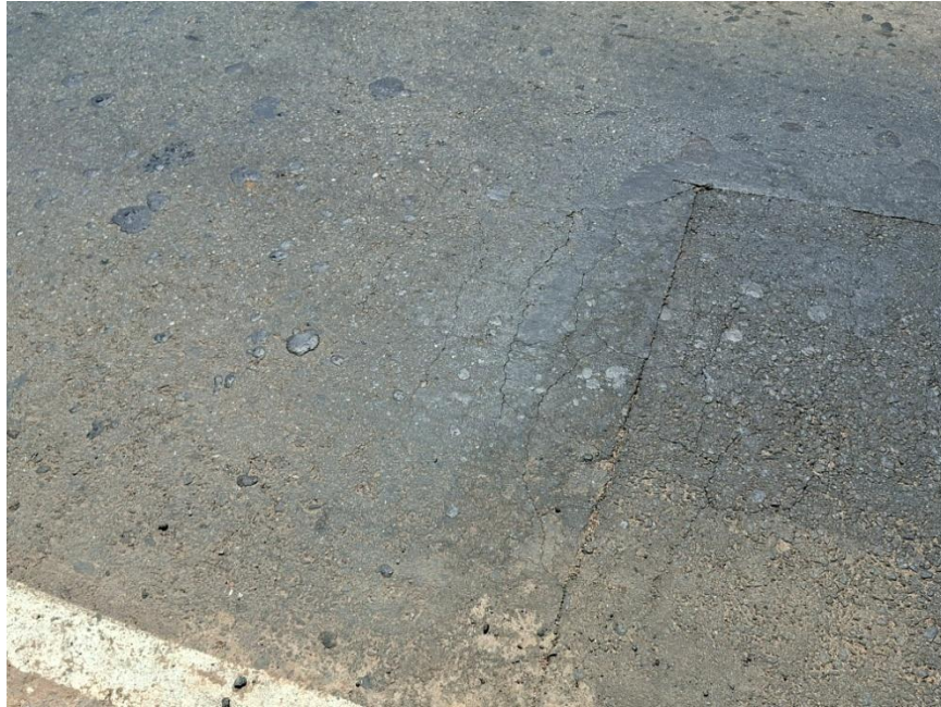
Imagem 32: Trecho do pavimento asfáltico danificado em trecho da avenida. –
