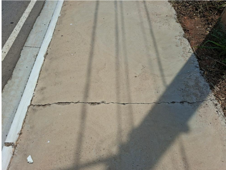
Imagem 46: Trincas em trecho de calçadas da avenida, com desprendimento de lascas do piso. – Arquivo da Secretaria Municipal de Planejamento Urbano e Meio Ambiente.
