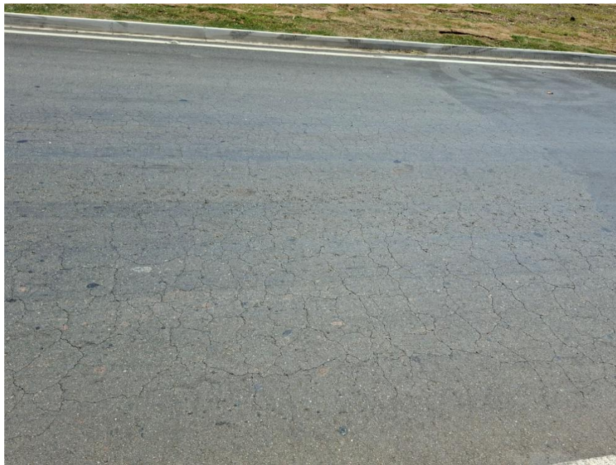
Imagem 25: Trecho do pavimento asfáltico danificado no trevo, nas proximidades da escada hidráulica. – Arquivo da Secretaria Municipal de Planejamento Urbano e Meio Ambiente.
