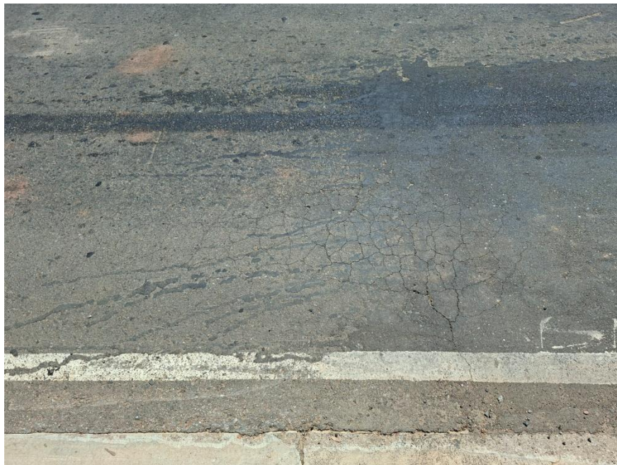
Imagem 37: Trecho do pavimento asfáltico danificado em trecho da avenida. –
