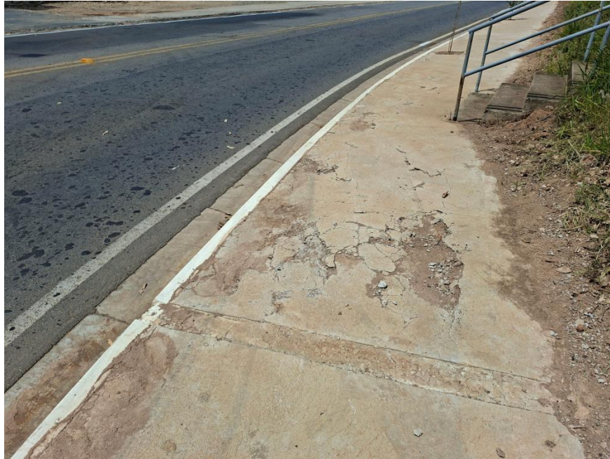
Imagem 48: Calçada danificada em trecho da avenida. – Arquivo da Secretaria Municipal de Planejamento Urbano e Meio Ambiente.
