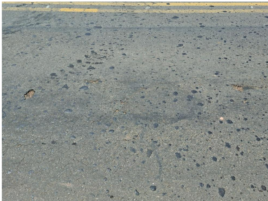
Imagem 33: Trecho do pavimento asfáltico danificado em trecho da avenida. –
