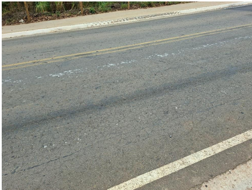
Imagem 41: Trecho do pavimento asfáltico danificado em trecho da avenida. –
