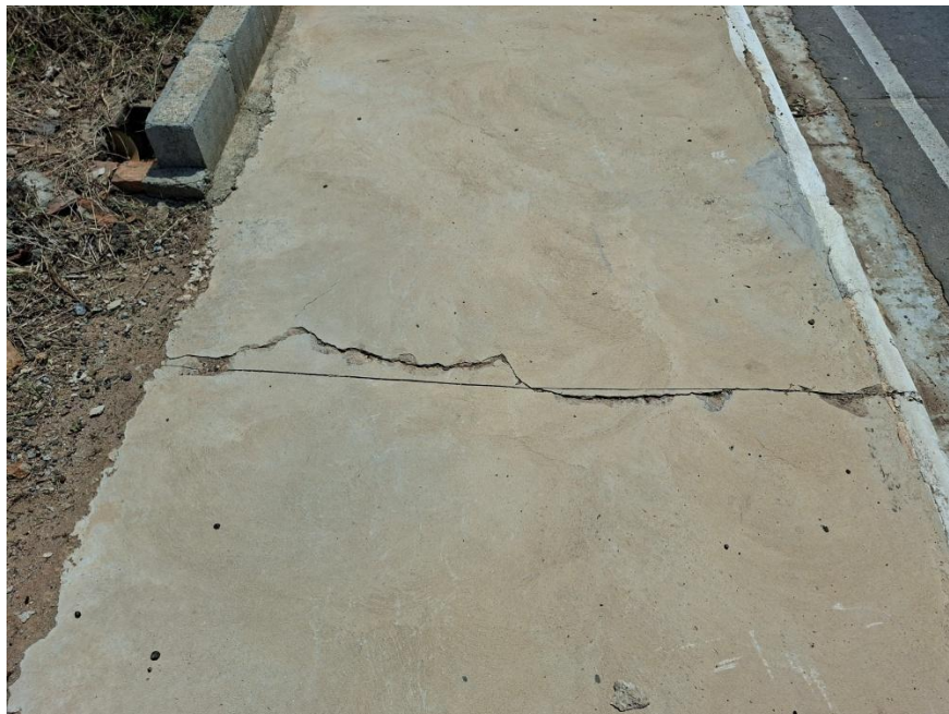
Imagem 45: Trincas em trecho de calçadas da avenida, com desprendimento de lascas do piso. – Arquivo da Secretaria Municipal de Planejamento Urbano e Meio Ambiente.
