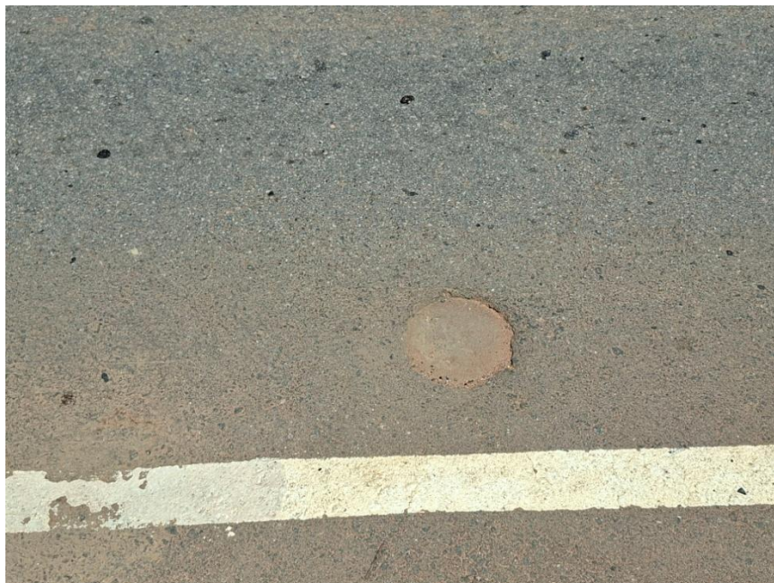
Imagem 31: Trecho do pavimento asfáltico danificado em trecho da avenida. – Arquivo da Secretaria Municipal de Planejamento Urbano e Meio Ambiente.
