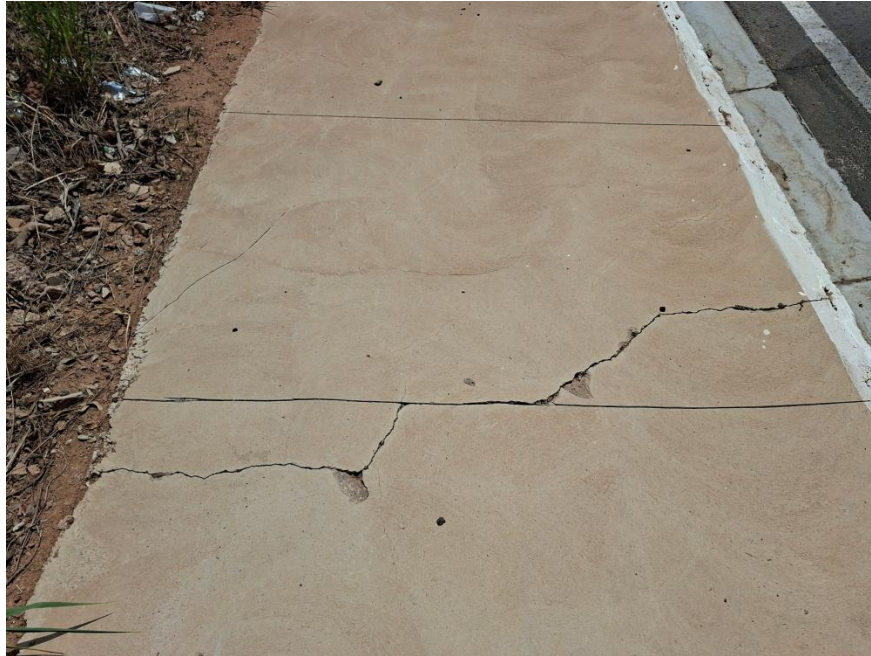
Imagem 44: Trincas em trecho de calçadas da avenida, com desprendimento de lascas do piso. – Arquivo da Secretaria Municipal de Planejamento Urbano e Meio Ambiente.
