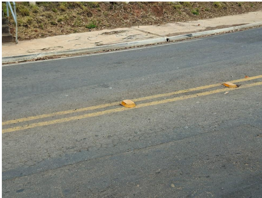
Imagem 39: Trecho do pavimento asfáltico danificado em trecho da avenida. – Arquivo da Secretaria Municipal de Planejamento Urbano e Meio Ambiente.
