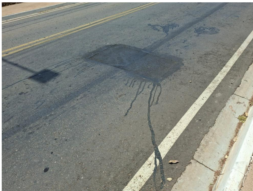
Imagem 43: Trecho de sinalização horizontal da avenida danificada pelos reparos realizados. – Arquivo da Secretaria Municipal de Planejamento Urbano e Meio Ambiente.
