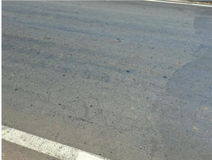
Imagem 24: Trecho do pavimento asfáltico danificado no trevo, nas proximidades da escada hidráulica. – Arquivo da Secretaria Municipal de Planejamento Urbano e Meio Ambiente.
