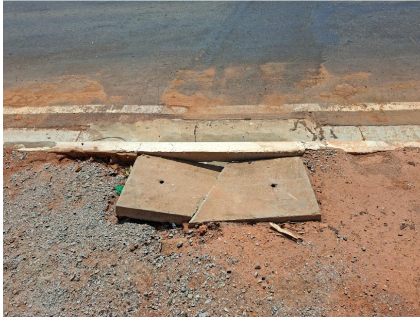
Imagem 30: Tampa de boca de lobo quebrada em trecho adjacente entre o trevo e avenida– Arquivo da Secretaria Municipal de Planejamento Urbano e Meio Ambiente.
