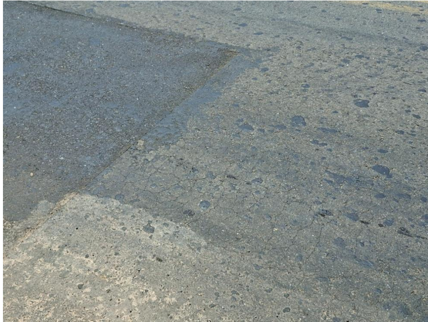
Imagem 36: Trecho do pavimento asfáltico danificado em trecho da avenida. –
