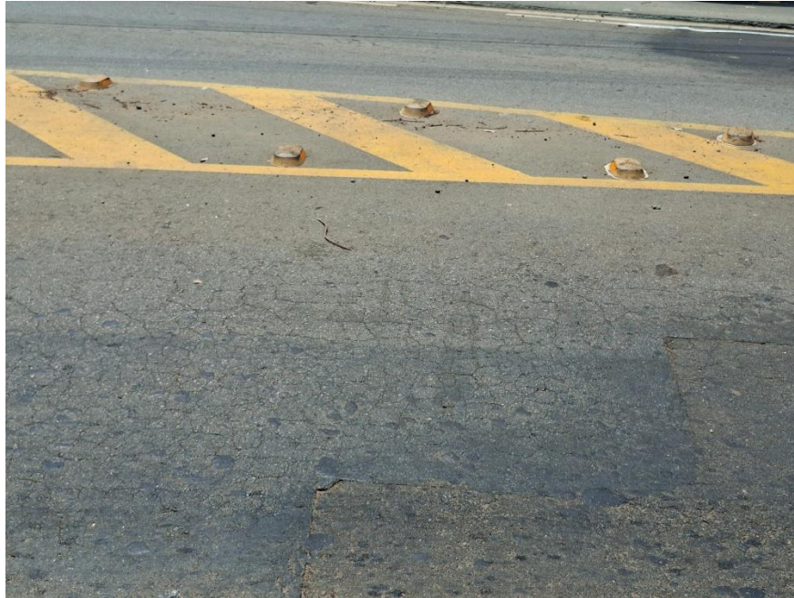
Imagem 38: Trecho do pavimento asfáltico danificado em trecho da avenida. – Arquivo da Secretaria Municipal de Planejamento Urbano e Meio Ambiente.
