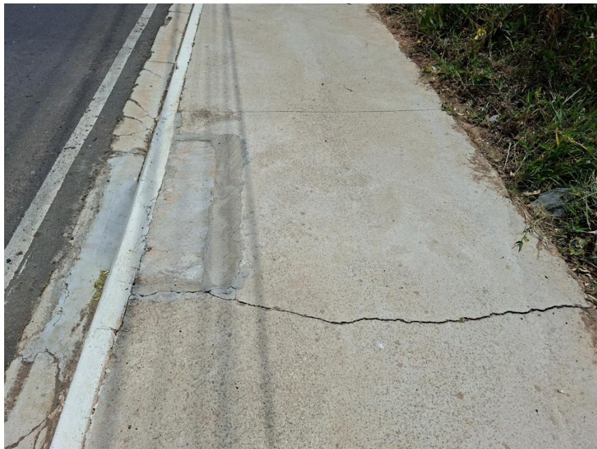
Imagem 47: Trincas em trecho de calçadas da avenida, com desprendimento de lascas do piso. – Arquivo da Secretaria Municipal de Planejamento Urbano e Meio Ambiente.
