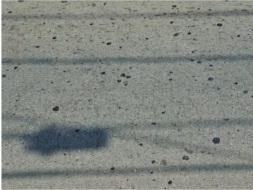
Imagem 34: Trecho do pavimento asfáltico danificado em trecho da avenida. – Arquivo da Secretaria Municipal de Planejamento Urbano e Meio Ambiente.
