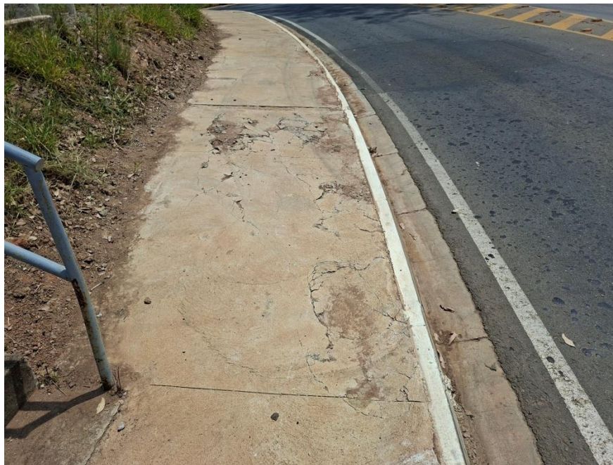
Imagem 49: Calçada danificada em trecho da avenida. – Arquivo da Secretaria Municipal de Planejamento Urbano e Meio Ambiente.
