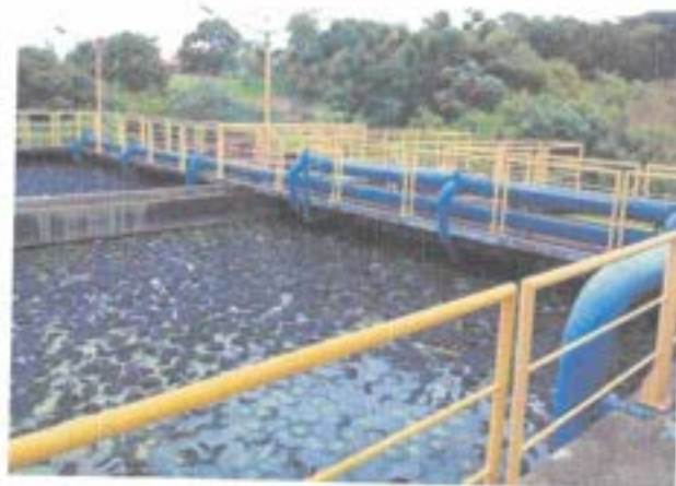
Figura 41 – Tanque de Aeração da ETE Barrinha
