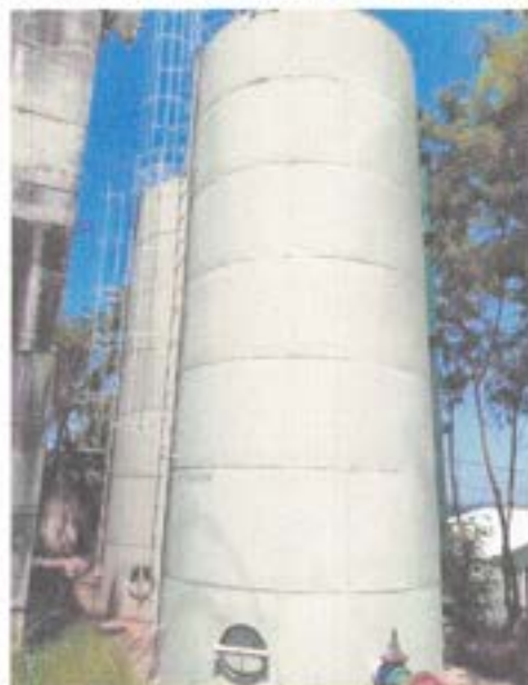
Figura 30 – Reservatórios cilíndricos inaugurados em 2015
