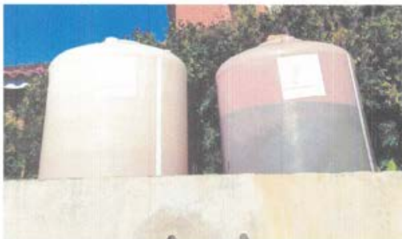
Figura 27 – Tanques de Armazenamento dos Insumos de Tratamento
