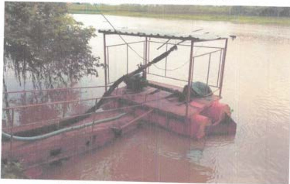
Figura 24 – Captação no Rio Paraíba do Sul
