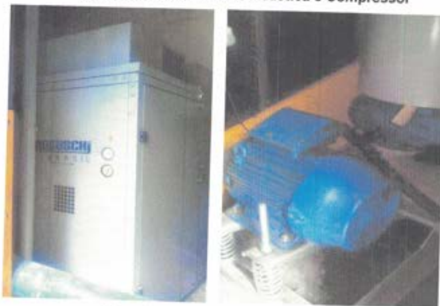
Figuras 42 e 43 – Cabine Acústica e Compressor
