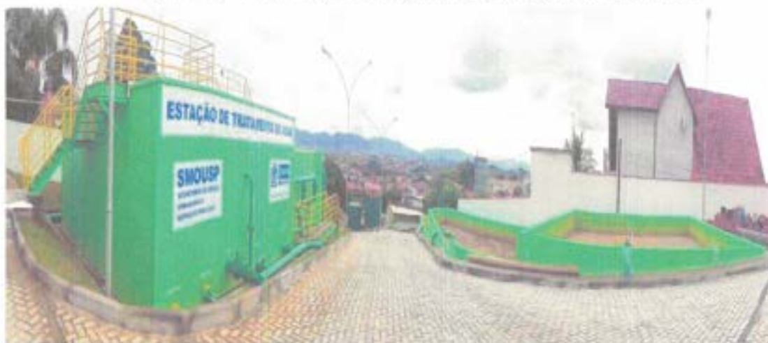
Figura 25 – ETA Bondarovsky Módulo Inaugurado em 2015
