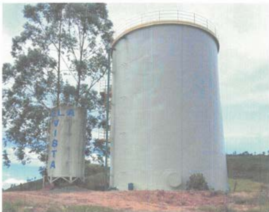
Figura 31 – Reservatório no Loteamento Bela Vista
