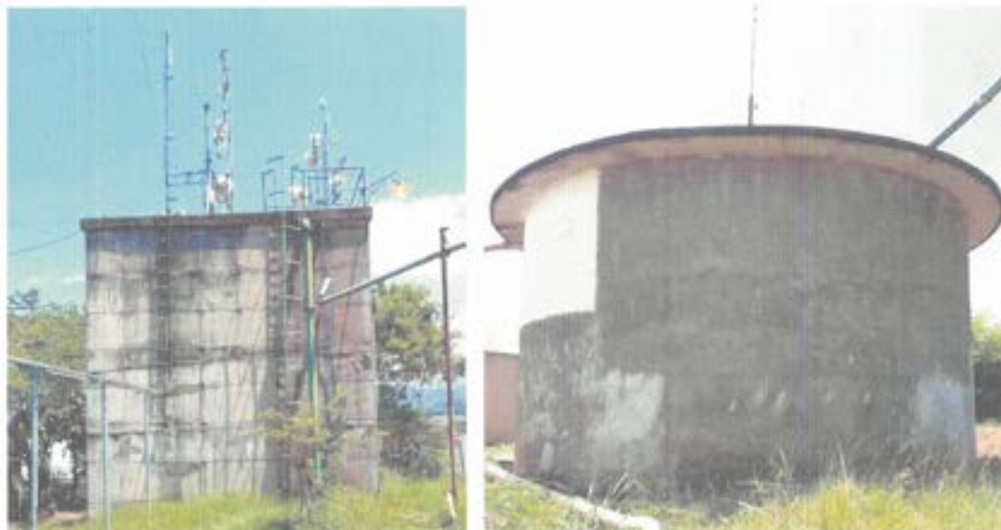
Figuras 28 e 29 – Reservatórios próximo da ETA Bondarovsky
