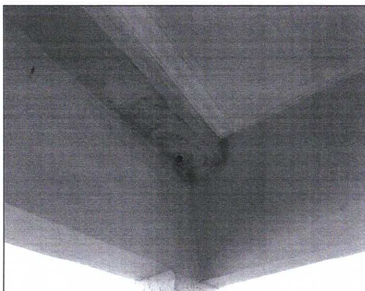
Figura 8 - Identificação de infiltração
