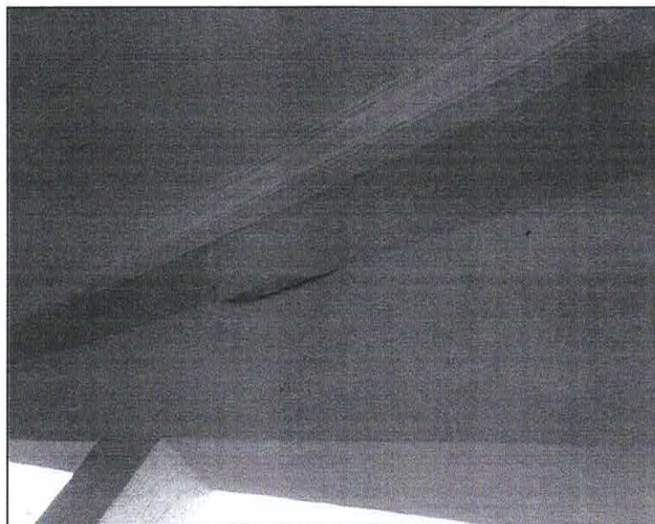
Figura 9 - Identificação de infiltração
