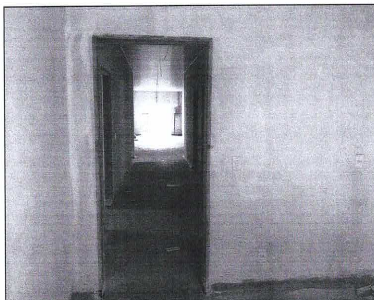
Figura 17 - Vão apenas com instalação de batente, sem porta
