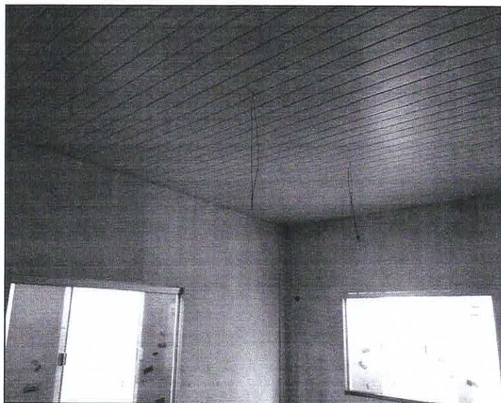
Figura 27 - Instalação elétrica, luminárias não instaladas
