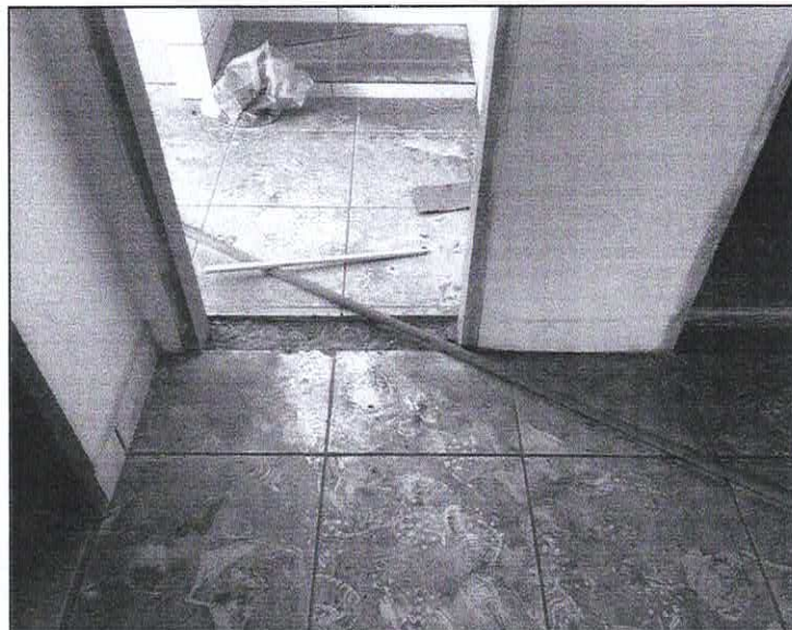
Figura 19 - Piso superior em cerâmica, necessitando de limpeza e instalação de soleiras
