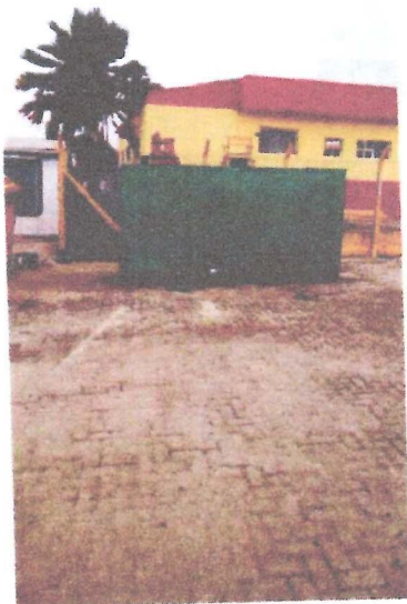
Gerador de energia à diesel
