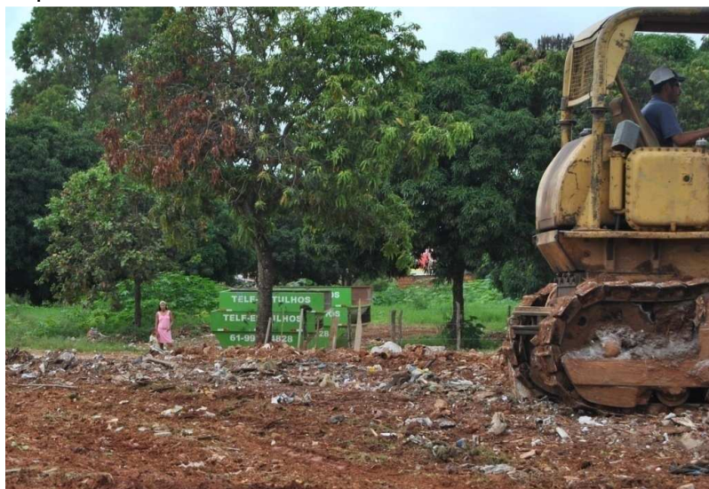
Figura 32: Catadores Individuais e Caçambas Armazenadas no Aterro Municipal de Inertes
