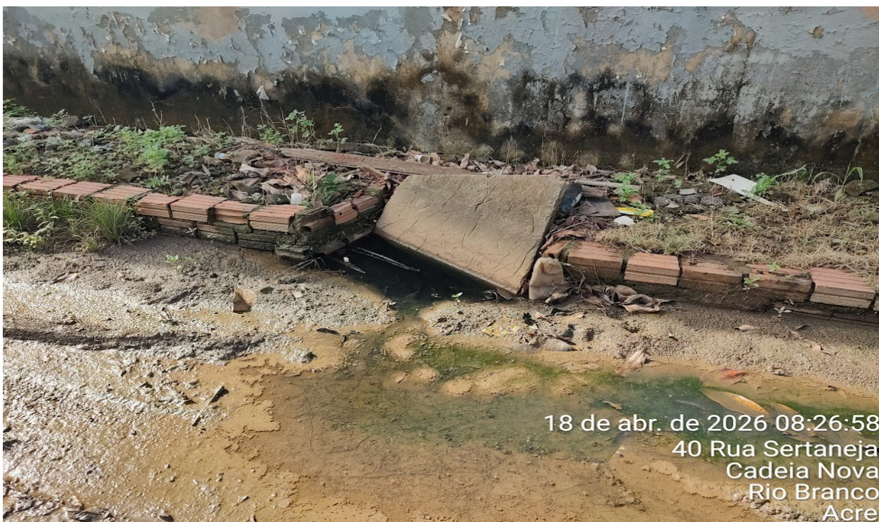
Problemas na drenagem (boca de lobo), pavimentação, calçada, meio fio
