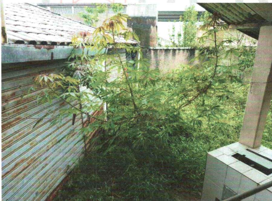
Figura 41 – Área externa, necessitando de capina, reparos de pintura, hidráulica e elétrica.
