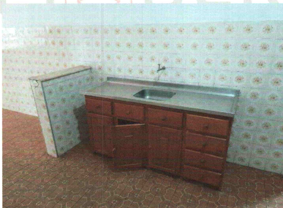
Figura 29 – Cozinha da residência, necessitando de reparos na pintura, armários e porta.
