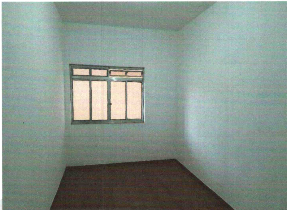
Figura 16 – Quarto n° 3, necessitando de reparos na pintura.
