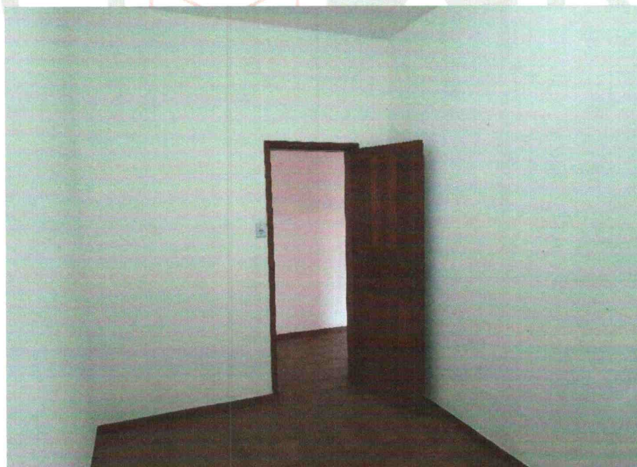
Figura 17 – Quarto n° 3, necessitando de reparos na pintura.
