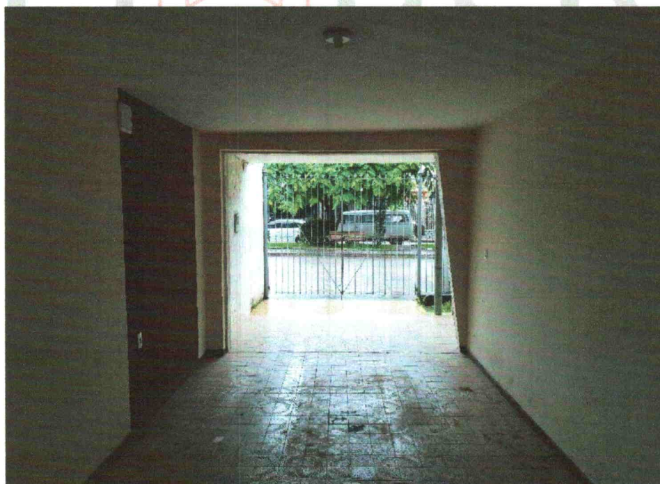
Figura 7 – Vista do interior da garagem, necessitando de reparos na pintura.
