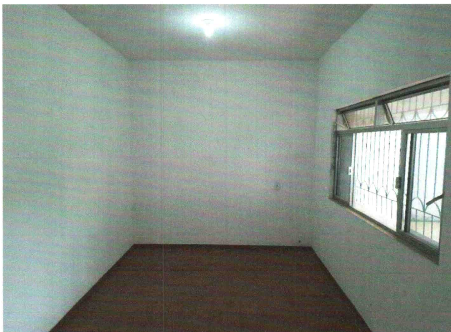
Figura 8 – Sala da casa, necessitando de reparos na pintura.
