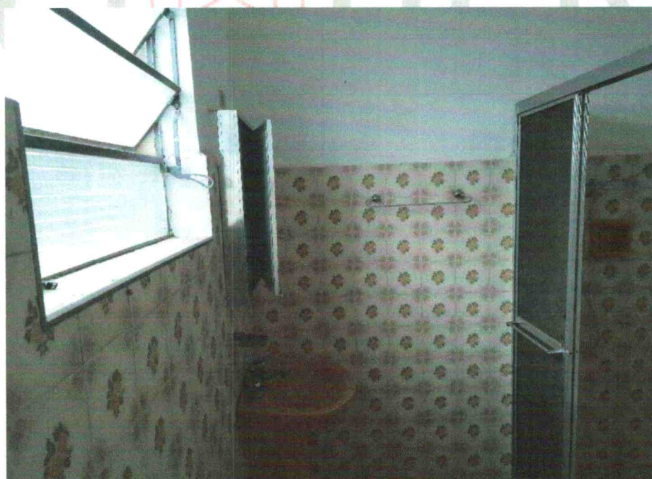
Figura 31 – Banheiro da copa, bastante danificado, com peças hidráulicas e elétricas quebradas e revestimentos danificados.
