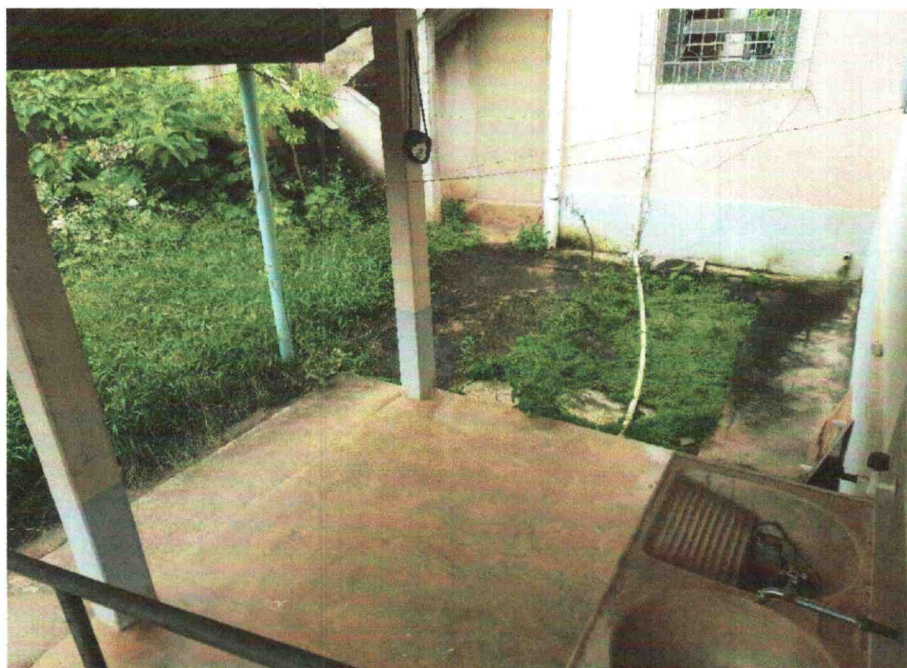
Figura 40 – Área externa, necessitando de capina, reparos de pintura, hidráulica e elétrica.
