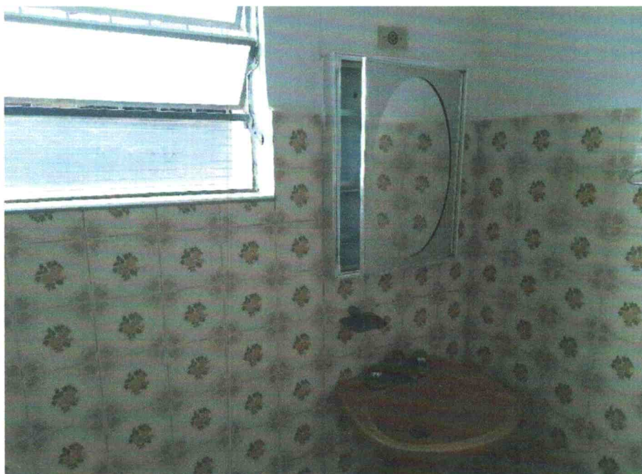
Figura 34 – Banheiro da copa, bastante danificado, com peças hidráulicas e elétricas quebradas e revestimentos danificados.
