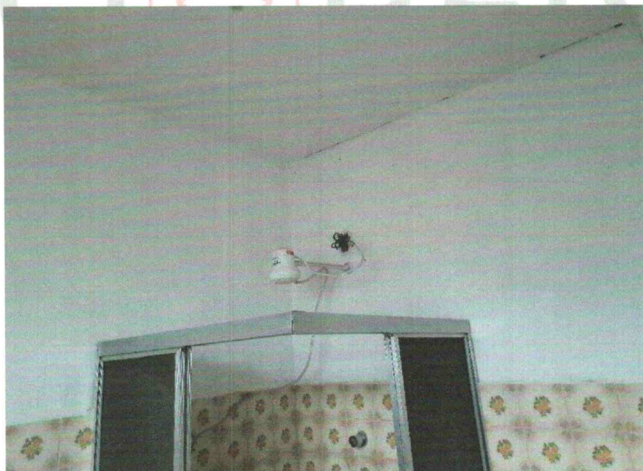
Figura 33 – Banheiro da copa, bastante danificado, com peças hidráulicas e elétricas quebradas e revestimentos danificados.
