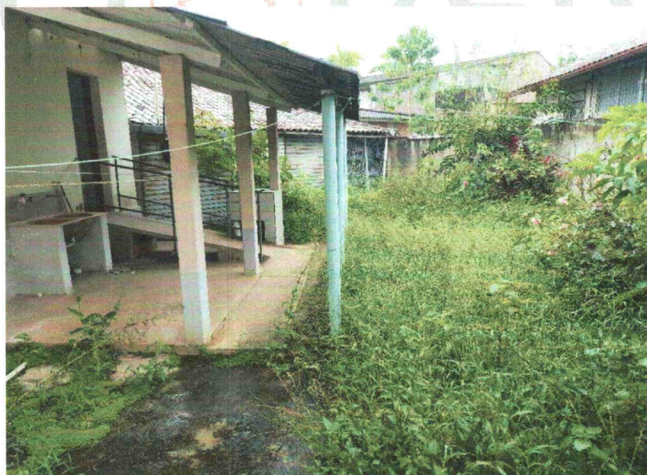
Figura 43 – Área externa, necessitando de capina, reparos de pintura, hidráulica e elétrica.
