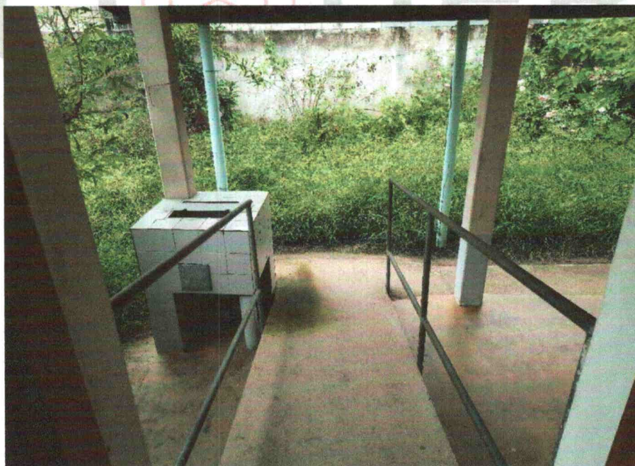
Figura 39 – Área externa, necessitando de capina, reparos de pintura, hidráulica e elétrica.
