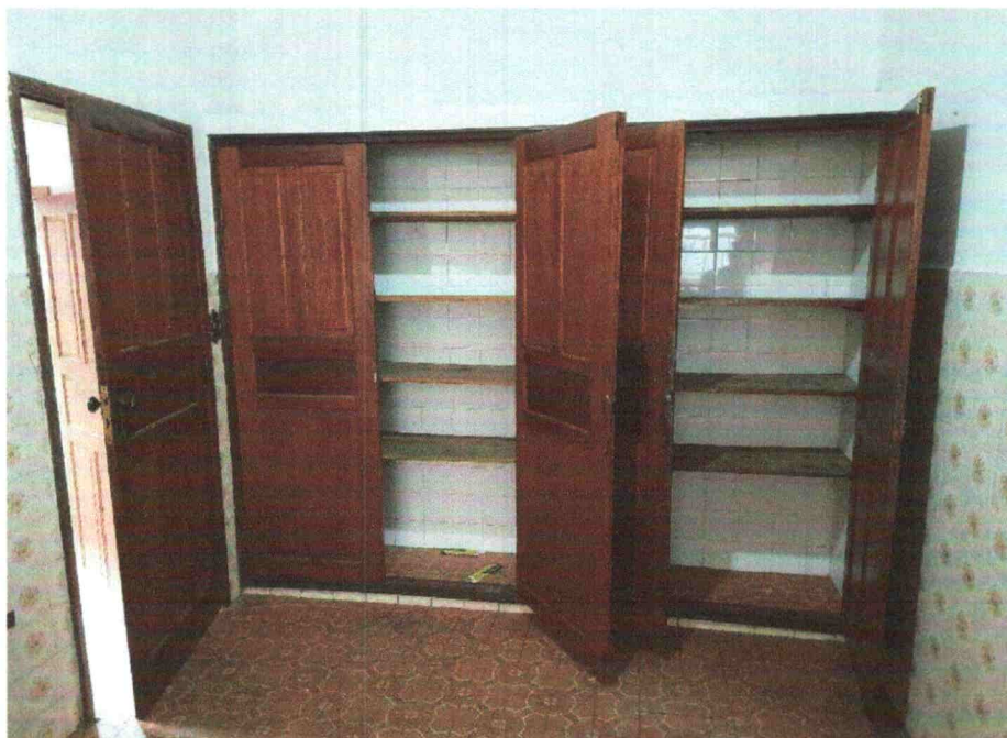
Figura 28 – Cozinha da residência, necessitando de reparos na pintura, armários e porta.
