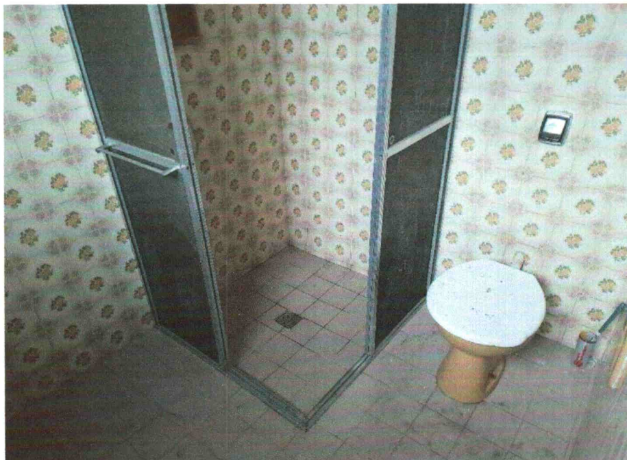
Figura 32 – Banheiro da copa, bastante danificado, com peças hidráulicas e elétricas quebradas e revestimentos danificados.
