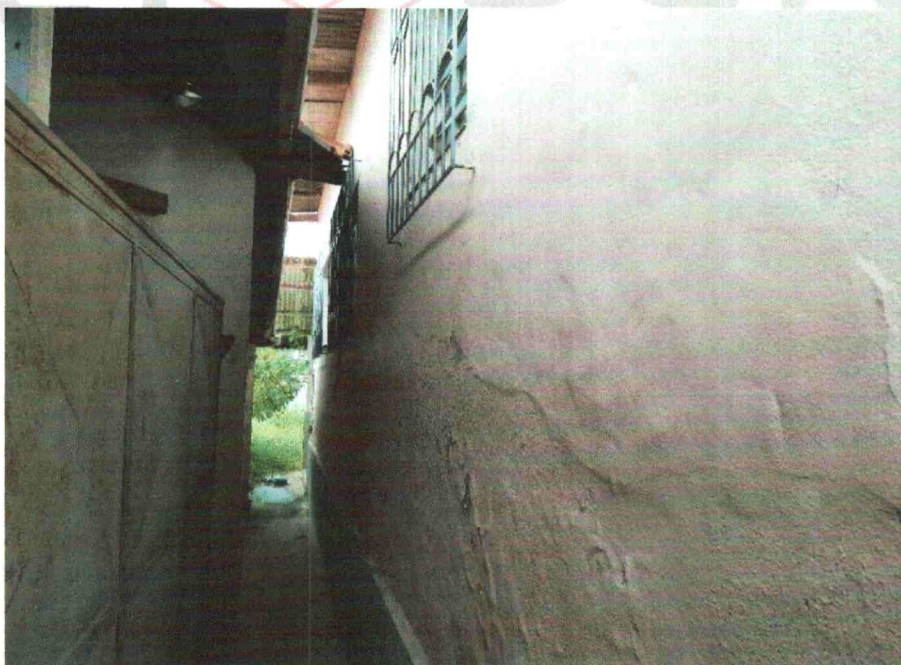
Figura 53 – Corredor nos fundos da edificação, necessitando de reparos na pintura.
