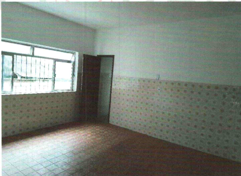
Figura 25 – Copa da residência, necessitando de reparos na pintura.
