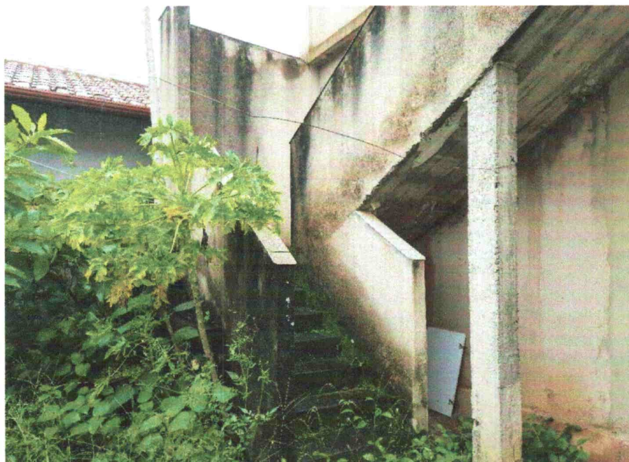
Figura 42 – Escada de acesso ao terraço coberto, necessitando de reparos de pintura.
