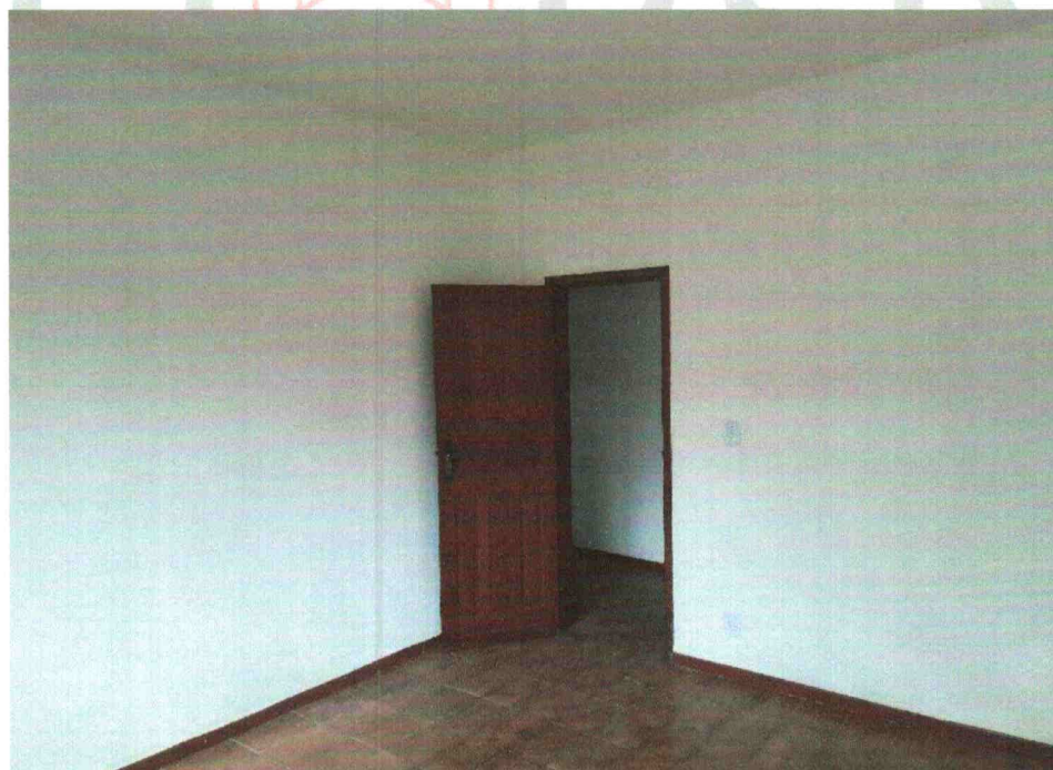
Figura 19 – Quarto n° 4, necessitando de reparos na pintura, está sem lâmpada.
