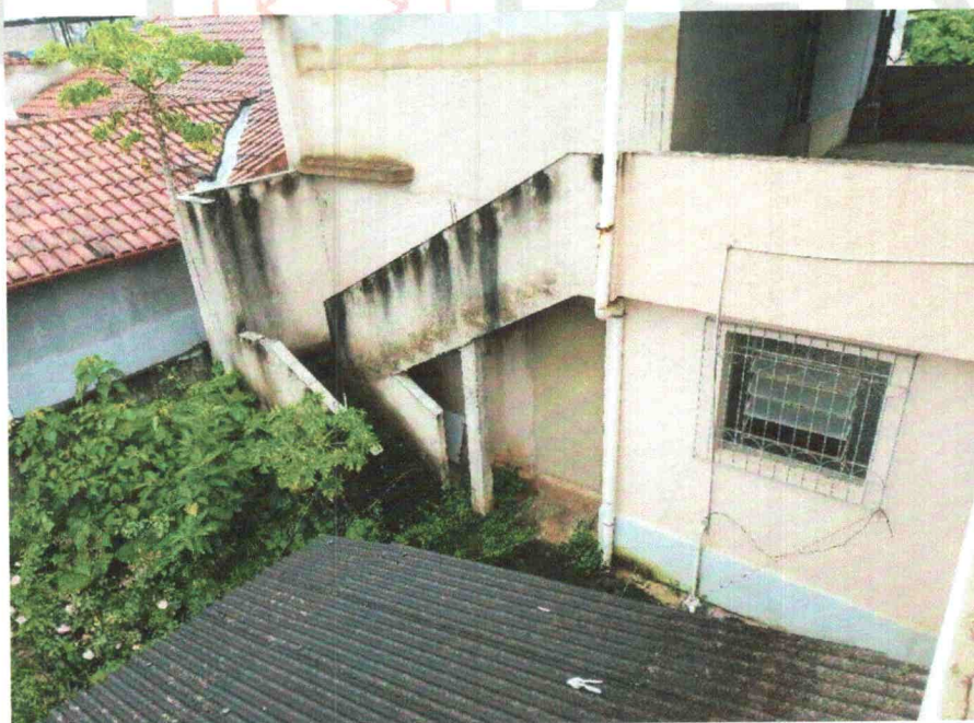
Figura 45 – Área externa, necessitando de capina, reparos de pintura, hidráulica e elétrica.
