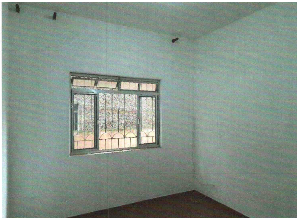
Figura 14 – Quarto nº 2, necessitando de reparos na pintura.
