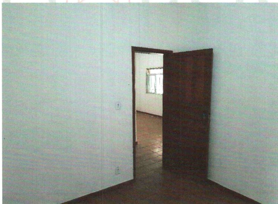
Figura 15 – Quarto nº 2, necessitando de reparos na pintura.
