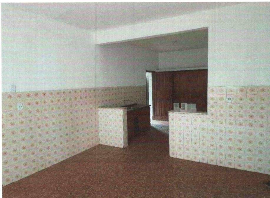
Figura 26 – Copa da residência, necessitando de reparos na pintura.
