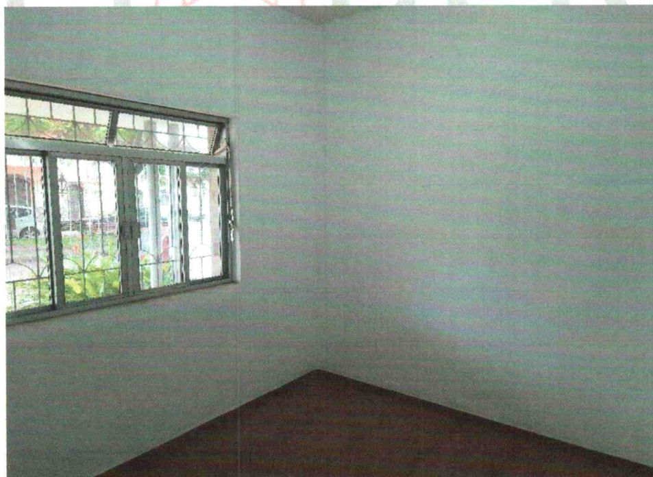
Figura 11 – Quarto n° 1, necessitando de reparos na pintura.
