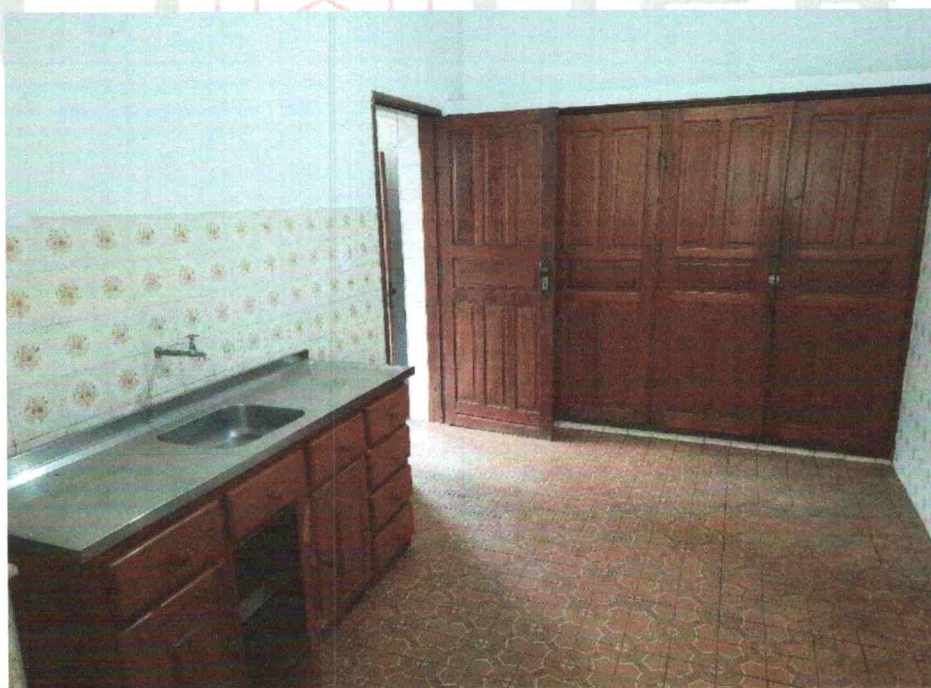
Figura 27 – Cozinha da residência, necessitando de reparos na pintura, armários e porta.
