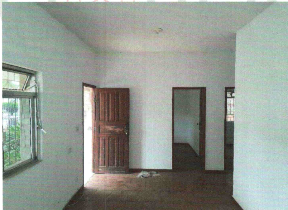
Figura 9 – Sala da casa, necessitando de reparos na pintura e manutenção na porta de entrada.
