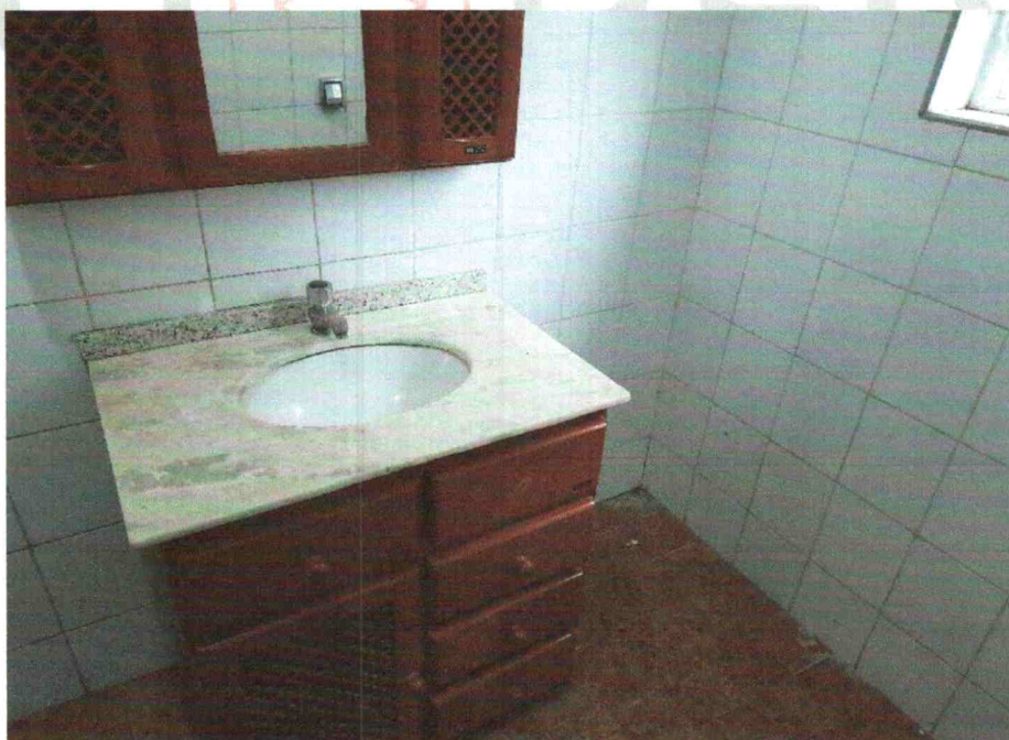
Figura 21 – Banheiro social, bastante danificado, com peças hidráulicas e elétricas quebradas e revestimentos danificados. Sem chuveiro.
