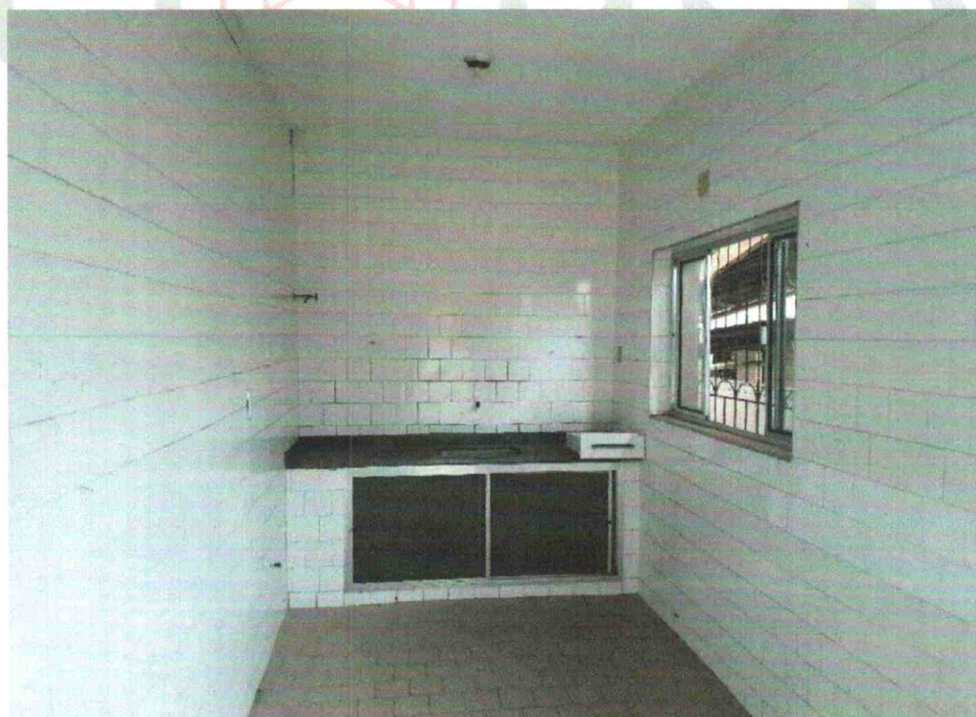
Figura 35 – Área de serviço, necessitando de reparos na pintura, cerâmicas, hidráulica e elétrica. Porta necessita de reparos.
