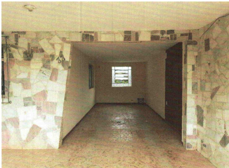
Figura 6 – Vista da fachada da garagem, necessitando de reparos na pintura.
