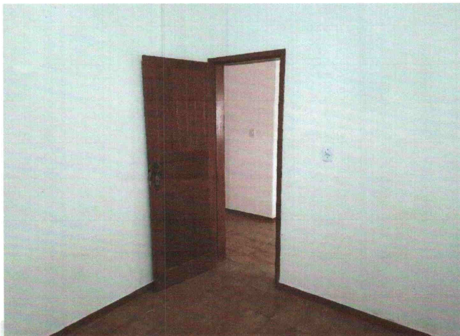
Figura 12 – Quarto n° 1, necessitando de reparos na pintura.
