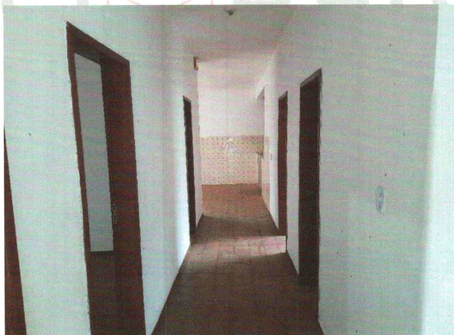
Figura 13 – Corredor da residência, necessitando de reparos na pintura.
