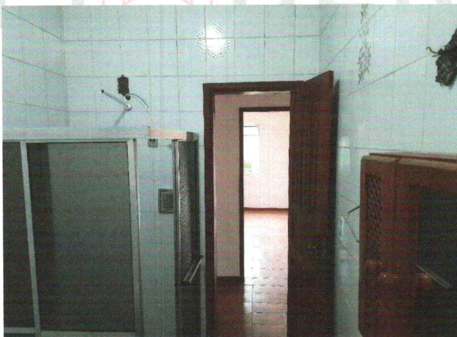
Figura 23 – Banheiro social, bastante danificado, com peças hidráulicas e elétricas quebradas e revestimentos danificados. Sem chuveiro.
