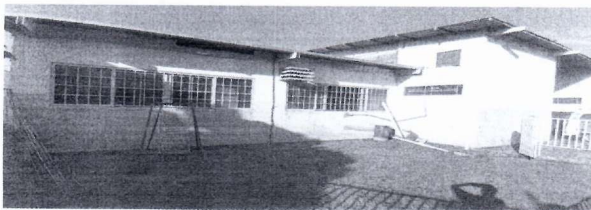
Área do fundo. Falha na vedação entre a cobertura e a fachada.
