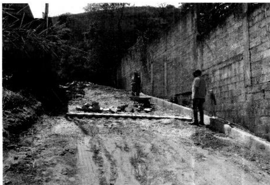
Bairro José Elói, rua Novo Horizonte (Final da rua)
